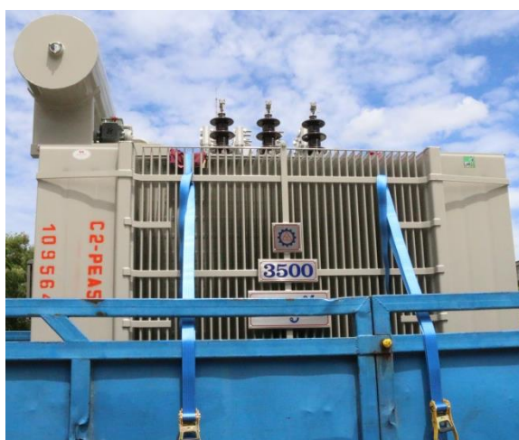
รูปที่ 3 หม้อแปลงไฟฟ้าระบบจำหน่ายขนาดใหญ่
