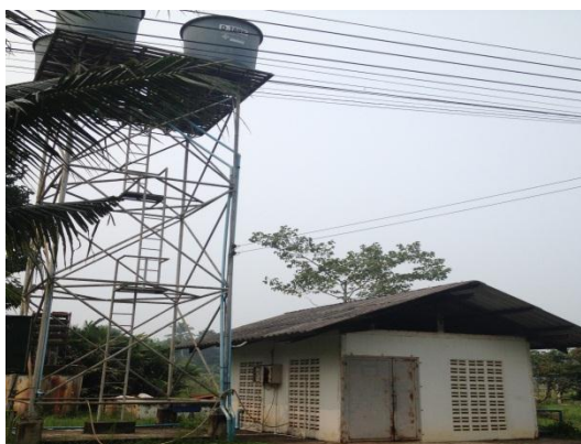
ภาพที่ 82 ท่อถังน้ำ
