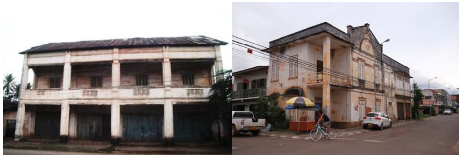
ภาพที่ 48 สภาพอาคารต้องซ่อมแซม
