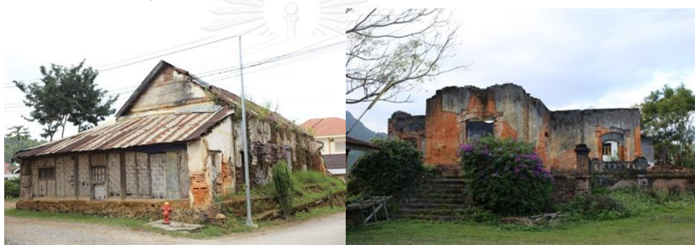
ภาพที่ 49 สภาพอาคารทรุดโทรมมาก
