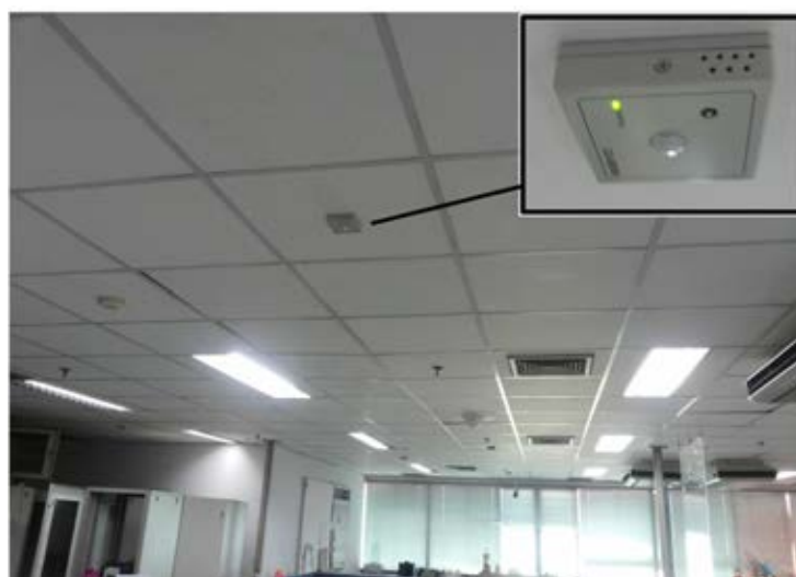
รูปที่ 3.6: ตำแหน่งการติดตั้งตัวรับรู้ไร้สาย ZigBee ภายในอาคารเจริญวิศวกรรม
