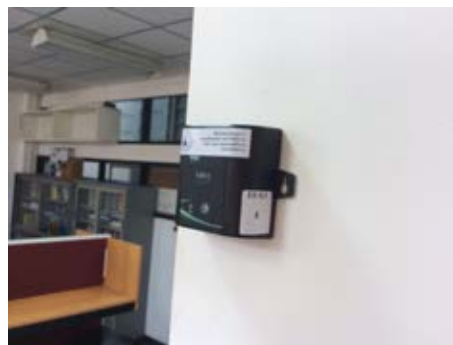
รูปที่ 3.8: การติดตั้งโนดตัวรับรูดชนิดแบตเตอรี่ภายในอาคารภาควิชาวิศวกรรมไฟฟ้า
