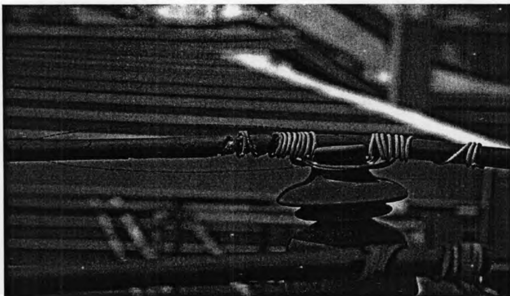
รูปที่ 2.9 ฉนวนหุ้มสายไฟฟ้าเสื่อมสภาพ
