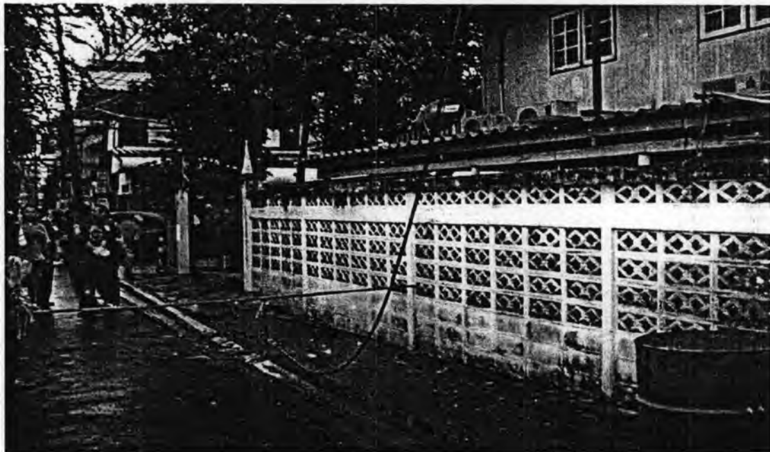
รูปที่ 2.15 สายไฟฟ้าขาดเป็นอันตรายต่อประชาชนที่สัญจรผ่าน
