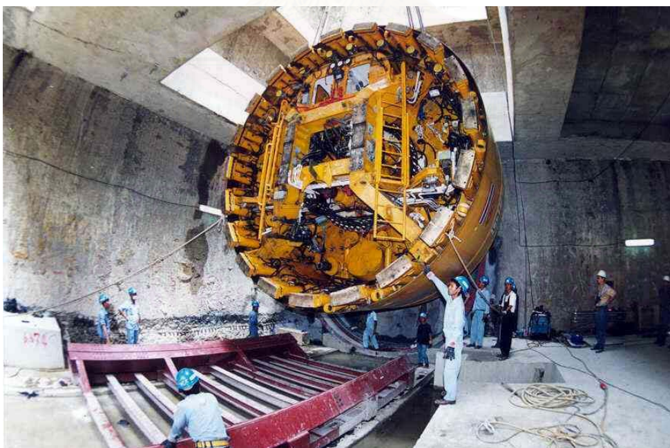
รูปที่ 3.16 แสดงการยกเครื่องขุดเจาะลงไปในสถานีเพื่อติดตั้ง
