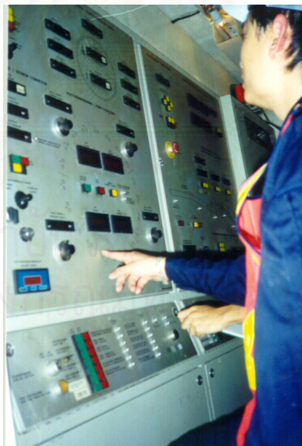
รูปที่ 3.29 แสดงห้องควบคุมทิศทางการขุดเจาะอุโมงค์
