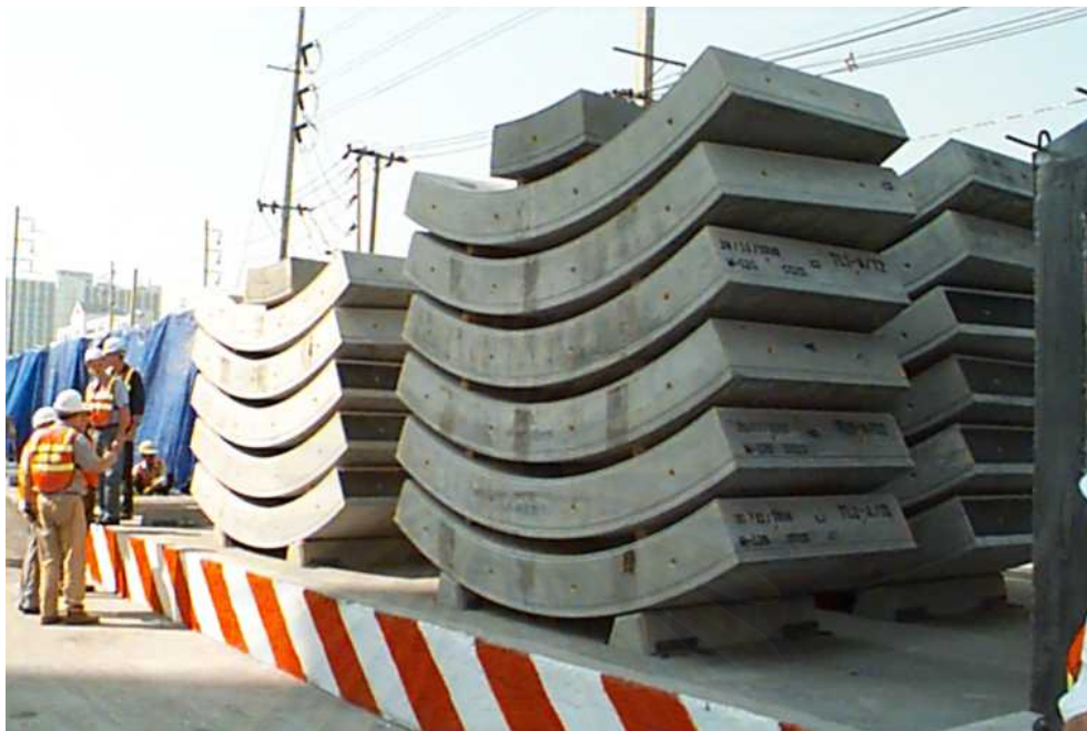
รูปที่ 3.24 แสดง Segment ที่จะติดตั้งเป็นผนังอุโมงค์
