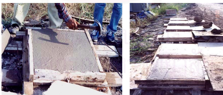
ภาพที่ 3-9 การฉาบผิวหน้าและทิ้งคอนกรีตให้แห้ง
