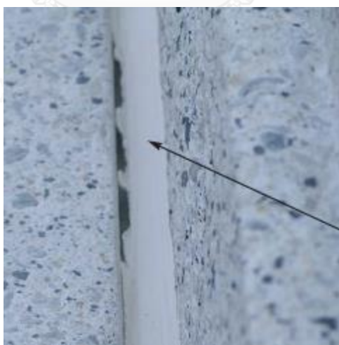
รูปที่ 2. 6 การพังจากการติดประสาน (adhesion failure) (CPCI 2000)
