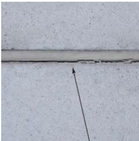
รูปที่ 2. 7 การพังจากการเคลื่อนที่ของรอยต่อ (cohesion failure) (CPCI 2000)
