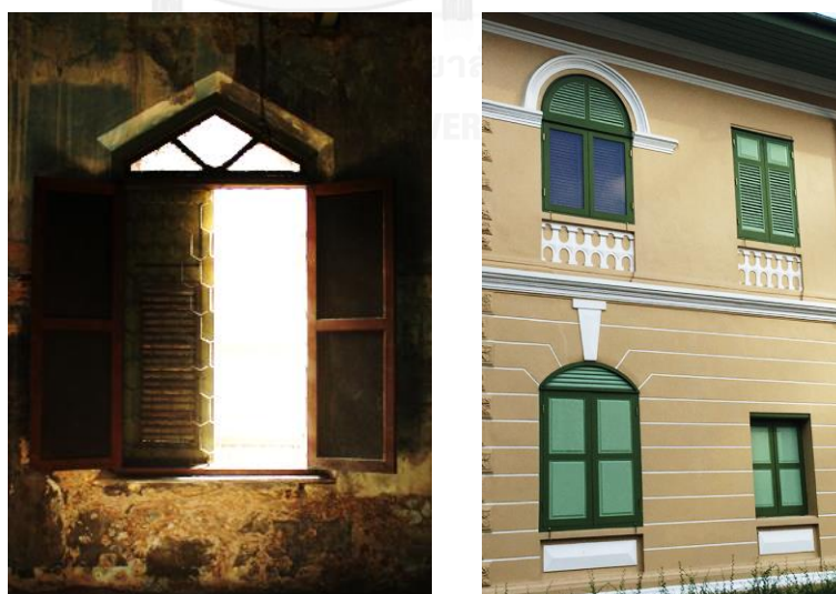
ภาพที่ 4 (ซ้าย) ช่องแสง ช่องลมเหนือประตูหน้าต่าง (ขวา) บานเปิดคู่แบบลูกฟัก
