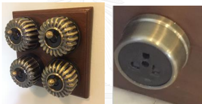
ภาพที่ 50 สวิตช์และปลั๊กไฟในอาคารบ้านเลขที่ 1 ซอยกัปตันบุช
