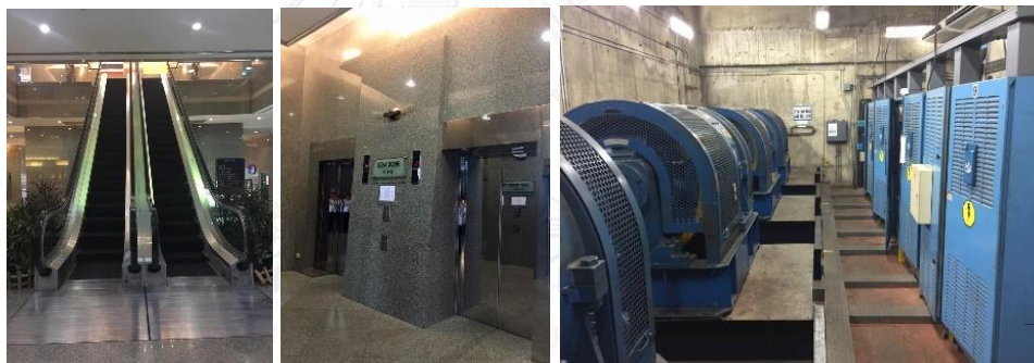
รูปที่ 36 ระบบลิฟต์และบันไดเลื่อน
