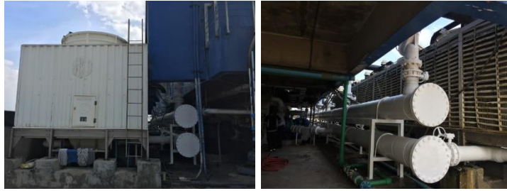
รูปที่ 37 ระบบปรับอากาศ
