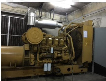
รูปที่ 28 ระบบไฟฟ้าฉุกเฉิน
