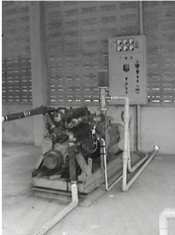
รูปที่ 5.1 ชุดเครื่องกำเนิดไฟฟ้าเหนี่ยวนำพร้อมอุปกรณ์ควบคุม
