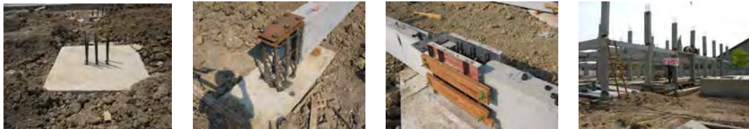
ภาพที่ 6.11 แสดงการติดตั้งเสาคานสำเร็จรูป
