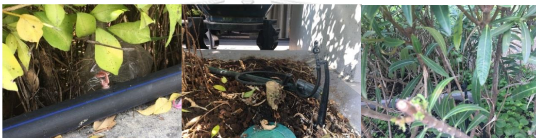
ภาพที่ 4 - 6 หัวจ่ายน้ำระบบน้ำหยด
