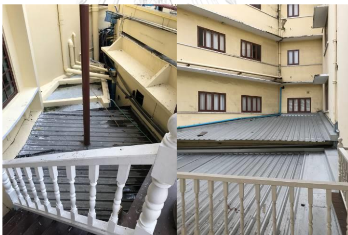
รูปที่ 40 หลังคาเมทัลชีทบริเวณรอยต่ออาคาร
