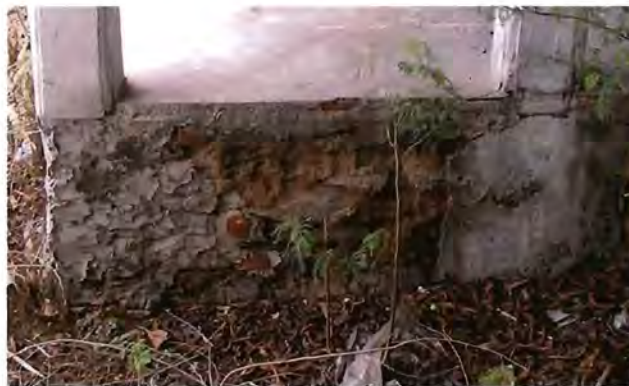
ภาพ ๔.๑๐๔ ฐานอาคารด้านทิศเหนือ เห็นรอยแตกร้าวของปูน
