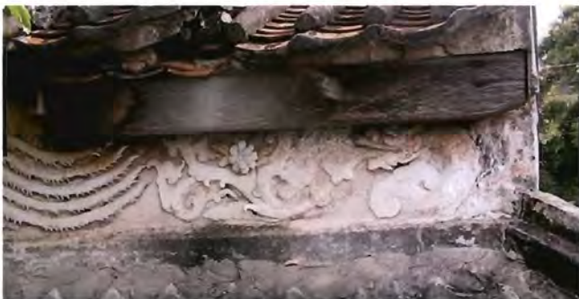
ภาพ ๔.๖๐ ผนังคอสองด้านทิศเหนือ ช่วงหน้าอาคารเป็นลายปูนปั้น เขียนสีประดับกระเบื้องเคลือบสี ซึ่งสีและปูนหลุดรอกไปมาก
