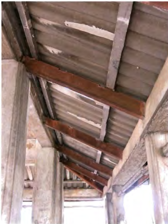
ภาพ ๔.๑๐๙ จันทันไม้ตัวเก่าบริเวณหลังคาปีกนก มีไม้ปิดหุ้ม สภาพเก่าเป็นคราบเล็กน้อย
