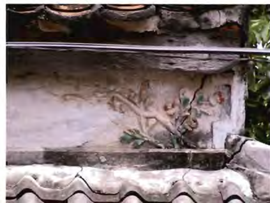
ภาพ ๔.๕๒ ผนังคอสองหลังอาคารทิศใต้ มีรอยร้าว
