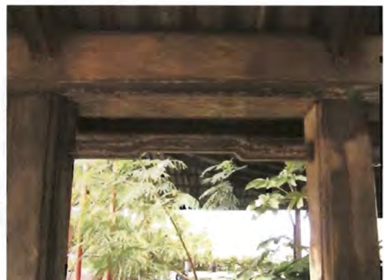
ภาพ ๔.๘๕ ไม้ตัวขวางประดับระหว่างเสา สภาพดีพอใช้ เนื้อสีหลุดลอกตามอายุอาคาร
