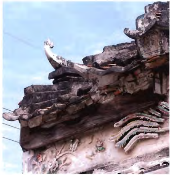
ภาพ ๔.๔๓ ชายคาหลังคาชั้นจั่วล่างติดไม้เชิงกลอนสภาพเก่า รับแนวกระเบื้องและมุมหลังคาเล็กด้านบน
