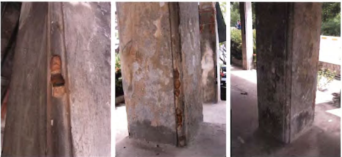
ภาพ ๔.๘๖-๔.๘๑ สภาพความเสียหายโดยรวมของเสารอบในอาคาร มีทั้งส่วนที่โดนกัดกร่อนเป็นคราบจากไอน้ำเค็ม ปูนกะเทาะหลุดล่อน บางจุดเห็นเนื้ออิฐภายใน สีและปูนเสื่อม บางจุดมีการขีดเขียนข้อความสกปรก
