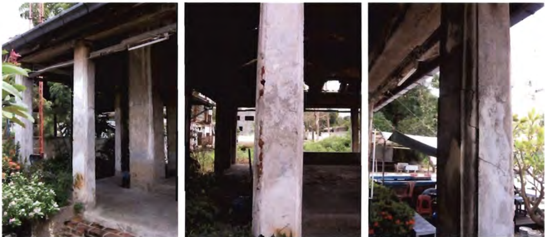
ภาพ ๔.๗๐-๔.๗๕ เสารอบนอกคูกกลางด้านทิศตะวันตก มีความเสียหายสูงสุด เสาแตกร้าว สีปูนกะเทาะหลุดอย่างรุนแรง เสาใกล้หัก ต้องนำไม้มาช่วยค้ำยัน ใอน้ำเค็มกัดกร่อน มีคราบดำและคราบสีอิฐที่แทรกทะลุตัวเสาออกมา
