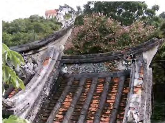
ภาพ ๔.๔๐ กรอบสันหลังคาจั่วชั้นล่างหน้าอาคารด้านทิศเหนือ ส่วนปลายยอดที่โค้งแอ่นแตกหัก ปูนปั้นรูปหัวมังกรคายก้านชดพฤกษชาติหลุดหายไป ตัวกรอบสันหลังคาและกรอบปิดจั่วมีสภาพเก่า สีและปูนฉาบหลุดล่อน ที่ผนังของสันหลังคาด้านนี้ตัวลายมีสภาพสมบูรณ์สุด
