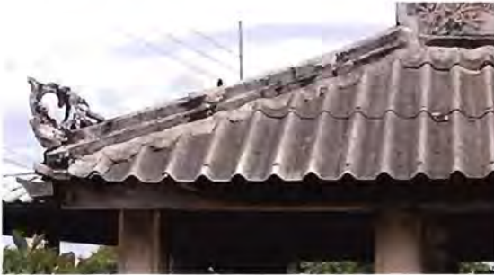
ภาพ ๔.๖๒ กันสาดปีกนกด้านทิศใต้ หน้าอาคาร ตรงมุมสี่แยกถนน ตัวครอบตะเข้สันเดิมเสื่อมสภาพแตกหัก ปูนและสีหลุดล่อน มีคราบดำ
