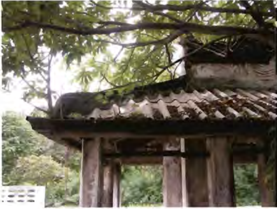
ภาพ ๔.๖๖ ปีกนกหลังอาคารด้านทิศเหนือ ครอบตะเข้สัน ปูนที่เก่า แตกหัก ปูนเสื่อม มีร่องรอยการซ่อม
