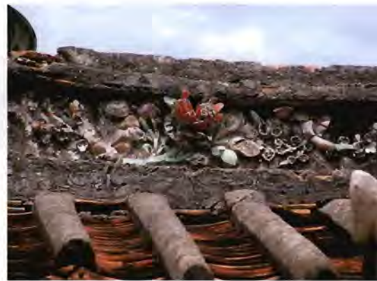
ภาพ ๔.๔๑ รูปขยายลวดลายบริเวณผนังสันหลังคาจั่วชั้นล่างหน้าอาคารด้านทิศใต้ เห็นการแตกหักของปูนปั้นและกระเบื้องเคลือบ เนื้อปูนมีร่องรอยกัดกร่อน สีหลุดล่อน ปูนเสื่อมสภาพ เกิดคราบดำ ไม่สวยงาม
