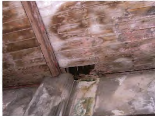
ภาพ ๔.๙๕ บริเวณมุมเสา มีรูรั่วของฝ้า ไม้ฝ้าเปื้อน แดก เนื้อไม้เสื่อม เป็นคราบ
