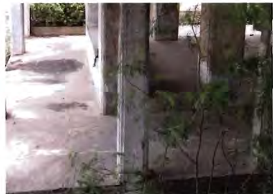
ภาพ ๔.๑๐๑ รอยน้ำขังที่พื้นด้านหลังอาคาร
