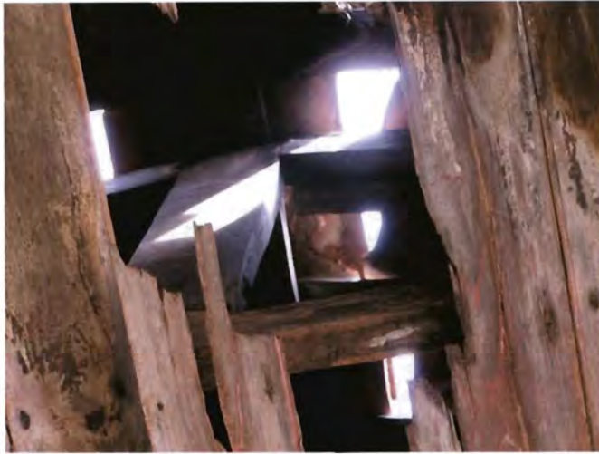
ภาพ ๔.๑๐๗ โครงสร้างหลังคาชั้นบนทรงจั่ว สังกัดชื่อไม้เก่าซึ่งเชื่อมตามอายุอาคาร และโดนน้ำฝนที่รั่วจากหลังคาทำลาย
