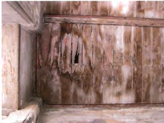
ภาพ ๔.๙๔ บริเวณมุมด้านหน้าอาคาร มีรูรั่วของฝ้า ไม้ฝ้า เปื้อน แดก เนื้อไม้เสื่อม เป็นคราบ
