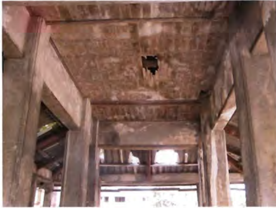
ภาพ ๔.๙๒ ฝ้าเพดานภายในตัวอาคาร ฝูพัง เปื้อน จาก น้ำฝนรั่วจากชั้นหลังคา
