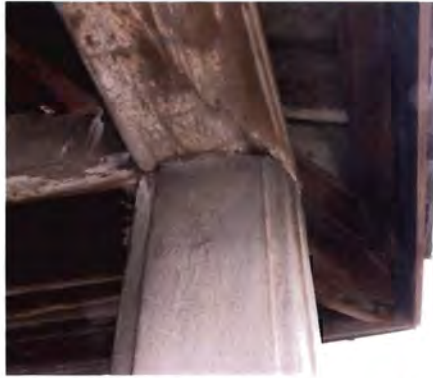
ภาพ ๔.๑๑๕ รอยแตกของคานทับหลังไม้ ตัวมม อาคารด้านทิศตะวันออกเฉียงใต้ ติดถนนใหญ่
