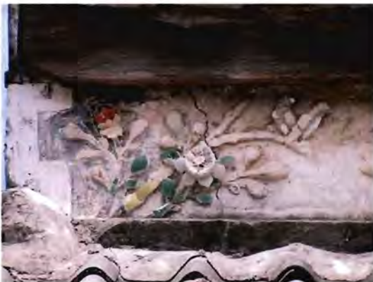
ภาพ ๔.๔๙ ผนังคอสองหน้าอาคารทิศใต้ มีรอยร้าว
