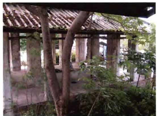
ภาพ ๔.๗๗ แนวเสาด้านทิศเหนือของอาคาร เห็นคราบการหลุดล่อนของสีและปูนฉาบ
