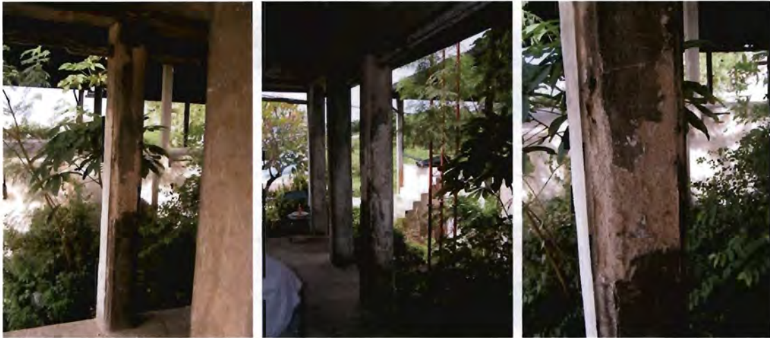
ภาพ ๔.๗๘-๔.๘๐ เสารอบนอกช่องกลางฝั่งหน้าอาคาร เป็นเสาที่เสียหายมากที่สุดในแนวเสาด้านทิศเหนือ เสาแตกร้า สีและเนื้อปูนเสื่อมเกาะทะลุหล่นชัดเจน มีคราบดำ
