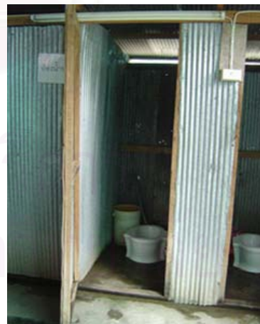
รูปที่ 13.6 ห้องส้วม
