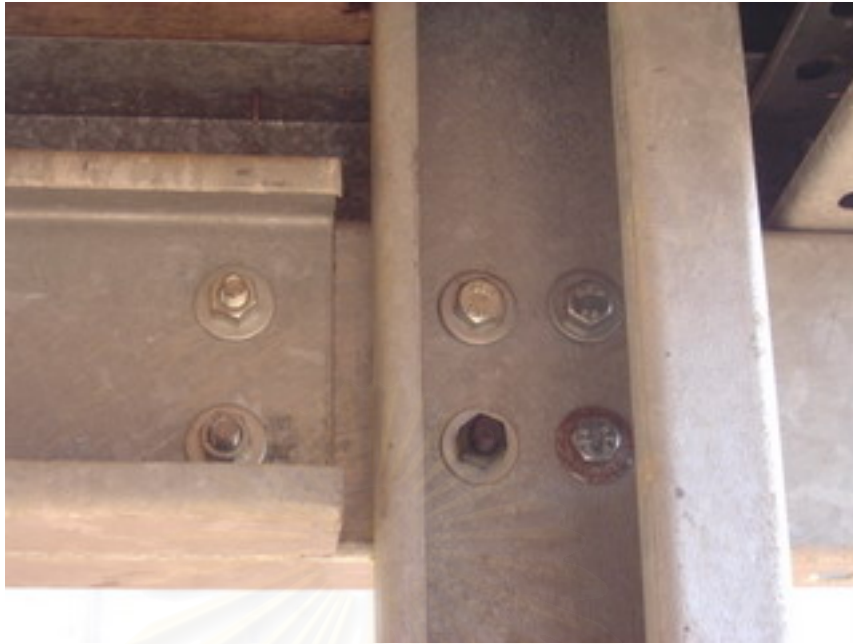
รูปที่ 4.39 รอยต่อระหว่างเสาและคาน
