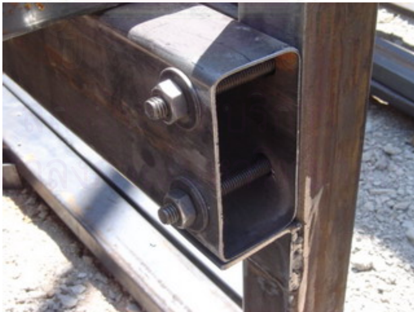
รูปที่ 5.24 การต่อยึดระหว่างเสากับคาน ใช้เหล็กฉากเป็นปาร์รับคาน
