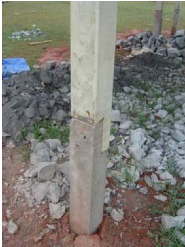
รูปที่ 4.26 รอยต่อระหว่างเสาตอม่อและเสาชั้นล่าง
