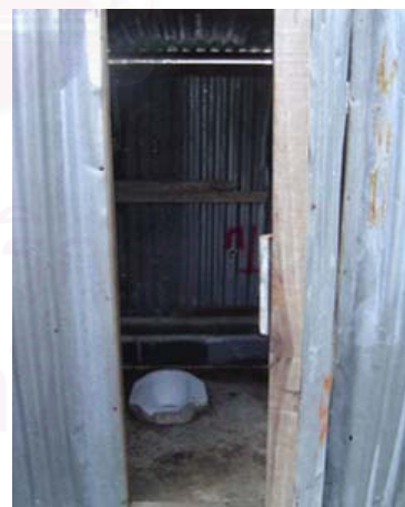
รูปที่ 8.6 ห้องส้วม
