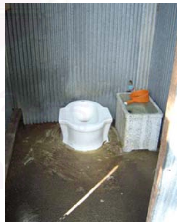
รูปที่ 32.6 ห้องส้วม
