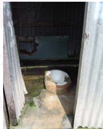
รูปที่ 21.6 ห้องส้วม
