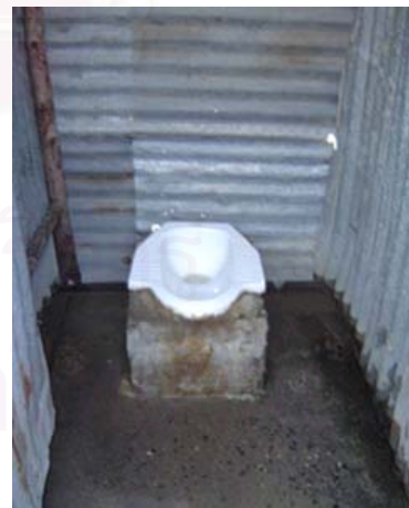
รูปที่ 30.6 ห้องส้วม
