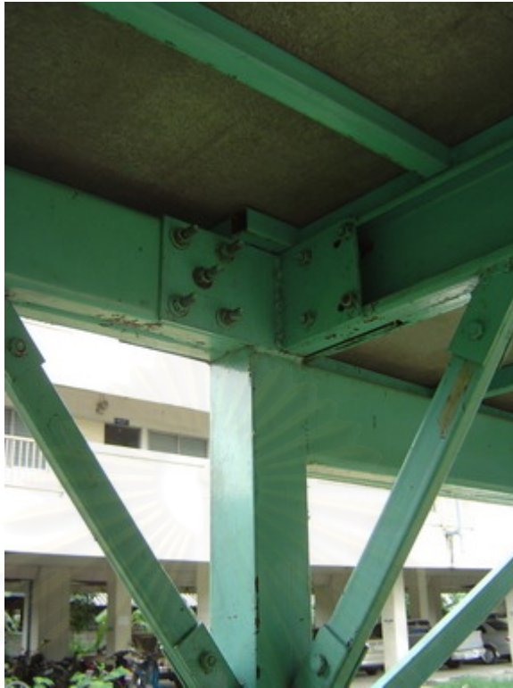
รูปที่ 4.9 รอยต่อระหว่างเสาและคาน
