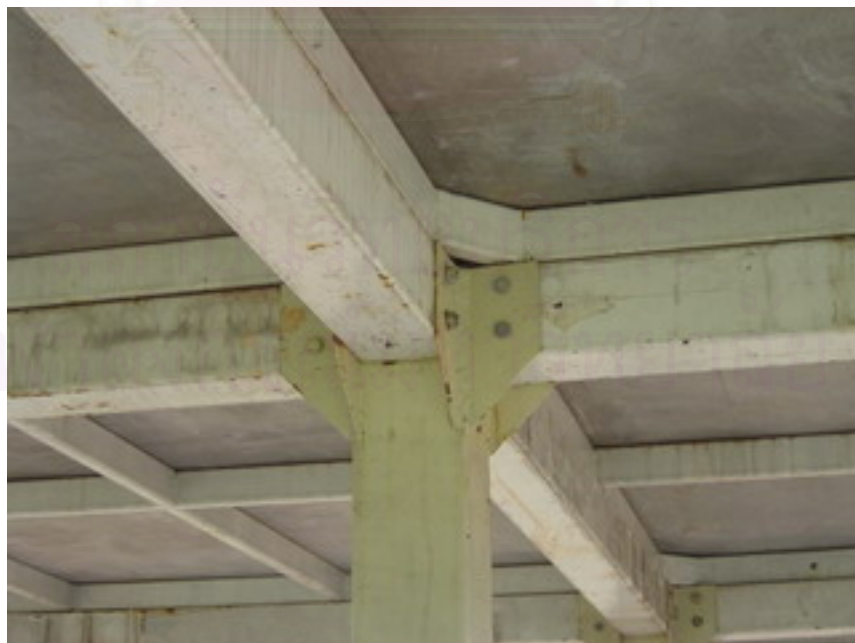
รูปที่ 4.27 รอยต่อระหว่างเสาและคาน
