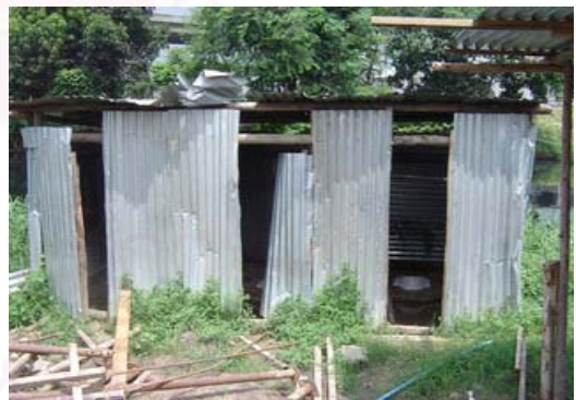
รูปที่ 2.6 ห้องส้วม
