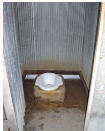
รูปที่ 28.6 ห้องส้วม
