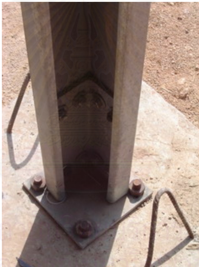
รูปที่ 4.38 รอยต่อระหว่างเสาและฐานราก
