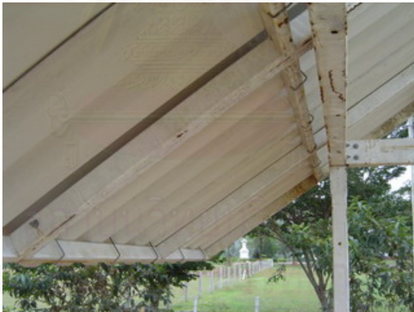
รูปที่ 4.31 รอยต่อระหว่างโครงหลังคาและกระเบื้องหลังคา
