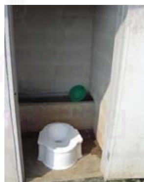
รูปที่ 33.12 ห้องส้วม
