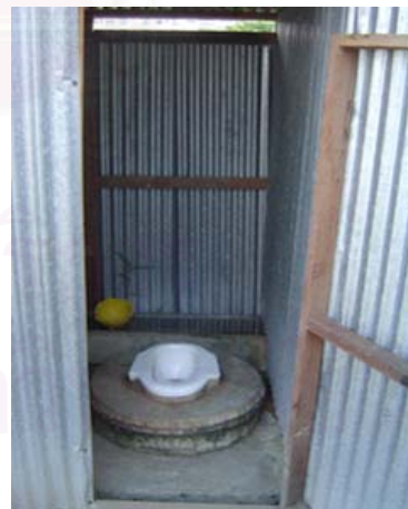
รูปที่ 29.6 ห้องส้วม
