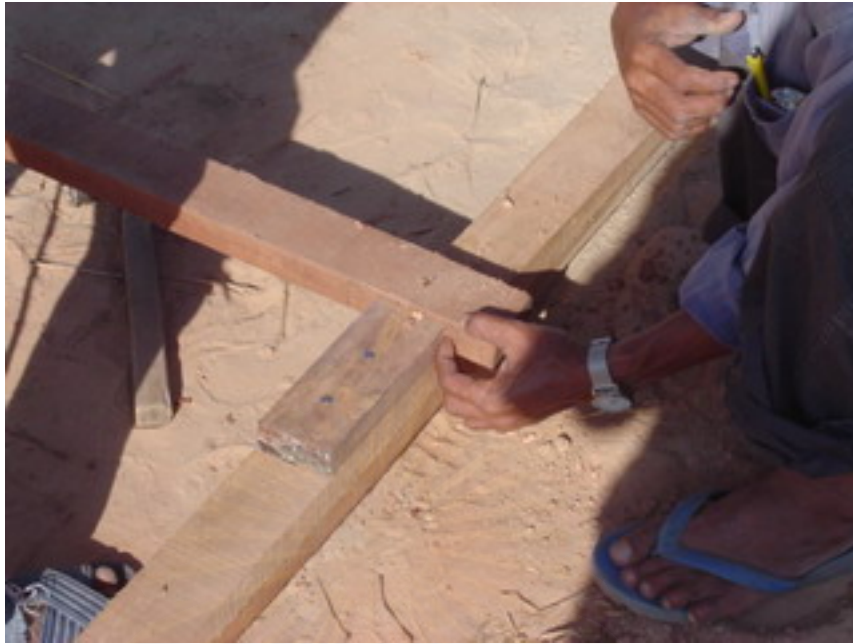
รูปที่ 5.7 ประกอบเสากับคานโดยใช้บ่ารองรับคาน
