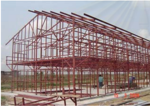
รูปที่ 33.3 อาคารที่พักอาศัยคนงานขณะก่อสร้าง
