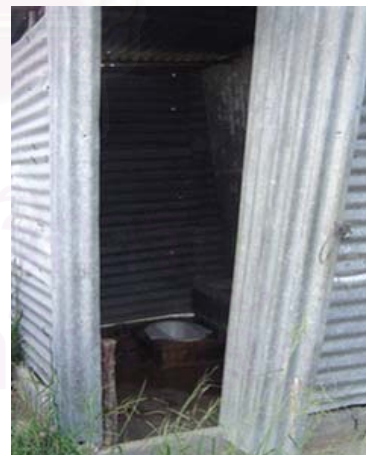
รูปที่ 24.6 ห้องส้วม
