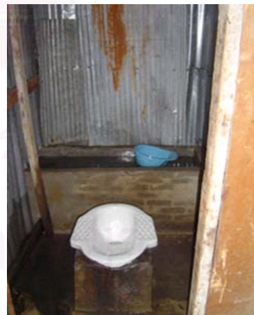
รูปที่ 27.6 ห้องส้วม
