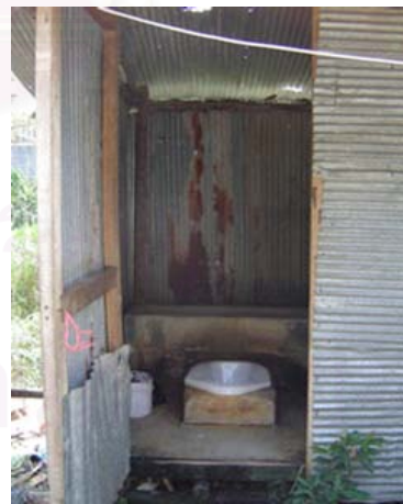
รูปที่ 31.6 ห้องส้วม
