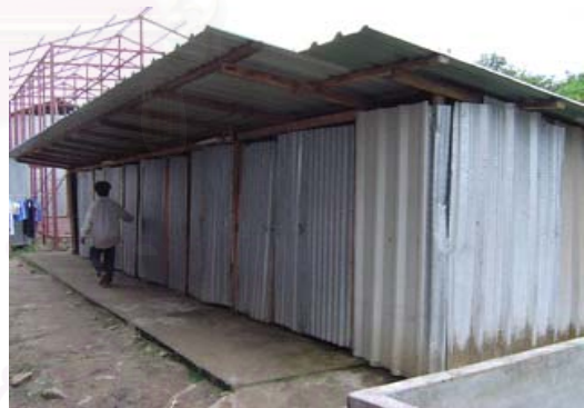
รูปที่ 6.6 ห้องส้วม
