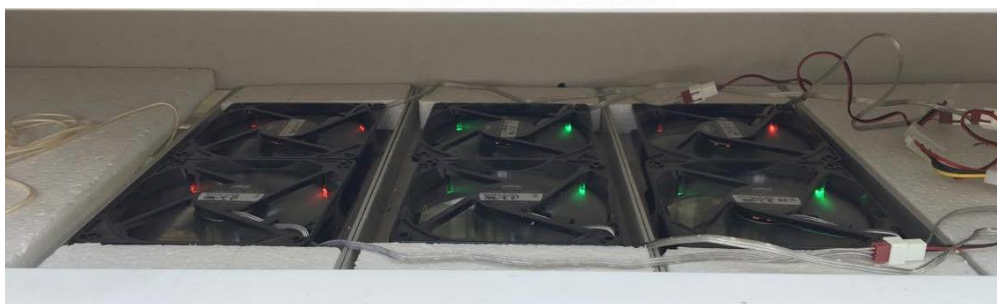
รูปที่ 3.3 พัดลม Cooler Master รุ่น SickerFlow ที่ใช้ในการทดลอง (บน) (ที่มา: http://apac.coolermaster.com/th/cooling/case-fan/sickleflow-x-non-led/ ) พัดลมที่ติดตั้งด้านบน Cavity (ล่าง)
