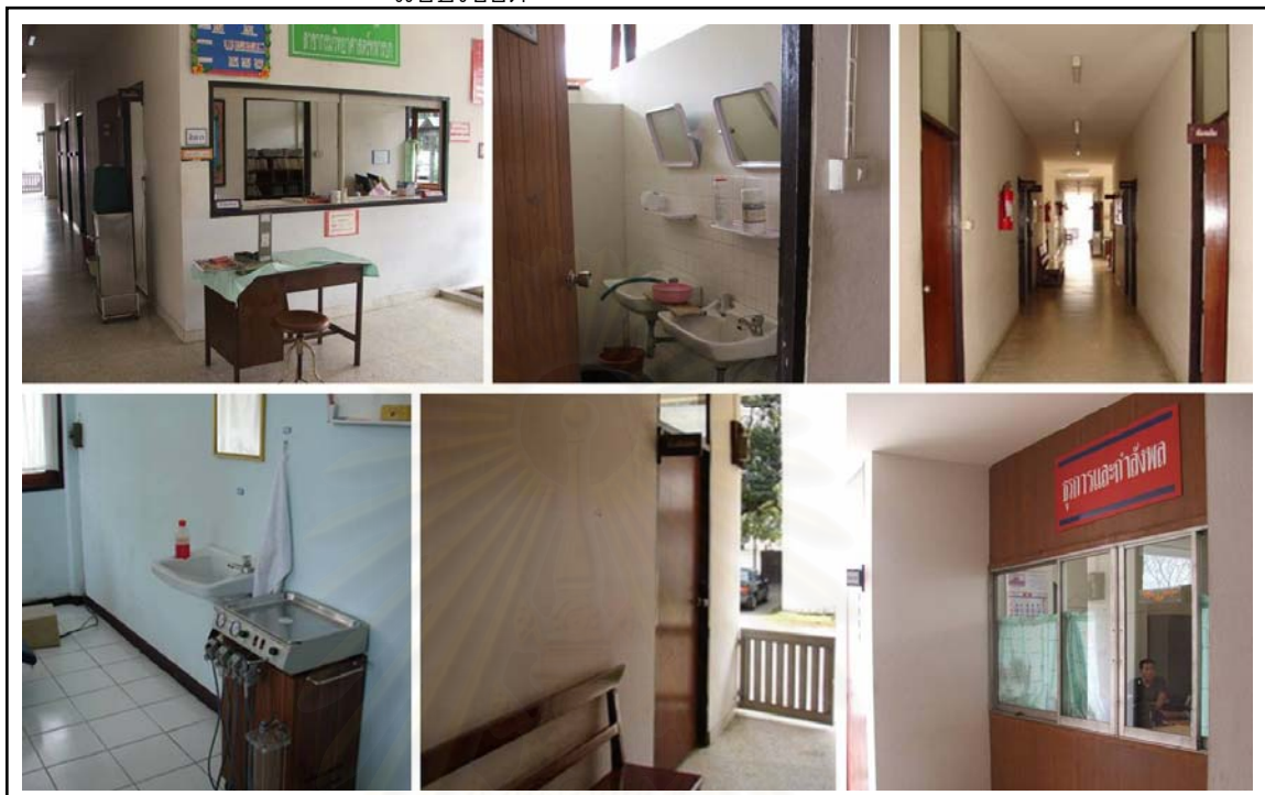
รูปภาพที่ 4.18 แสดงสภาพอาคารภายในอาคารหน่วยตรวจโรคที่ 12
