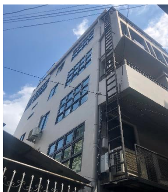
ภาพที่ 6.28 แสดงการติดตั้งบันไดหนีไฟภายนอกในรูปแบบที่เป็นบันไดแนวตั้ง(บันไดลิง) ไว้ในส่วนที่สามารถออกจากห้องพักได้เลยโดยไม่ต้องผ่านส่วนอื่น ที่มา : ผู้วิจัย
