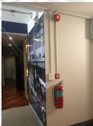
ภาพที่ 6.51 แสดงลักษณะการติดตั้งเครื่องแจ้งเตือนที่เป็นระบบแบบดึงมือ ในแต่ละชั้นตรงตามข้อกำหนดตามที่ระบุไว้เรื่องการติดตั้งระบบความปลอดภัยเพิ่มเติม
