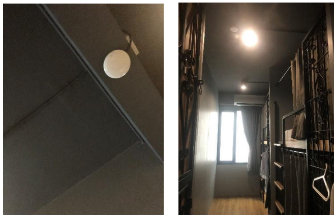
ภาพที่ 6.50 แสดงลักษณะการติดตั้งเครื่องตรวจจับควันไฟ ในพื้นที่ที่เป็นส่วนกลาง โถงทางเดิน และในพื้นที่ที่เป็นห้องพักในแต่ละชั้นตรงตามข้อกำหนดตามที่ระบุไว้เรื่องการติดตั้งระบบความปลอดภัยเพิ่มเติม
