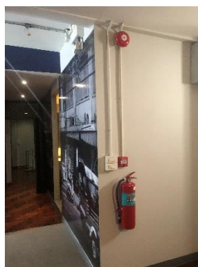
ภาพที่ 5.36 การติดตั้งระบบสัญญาณแจ้งเตือนด้วยมือในพื้นที่ทางสัญจรระหว่างห้องพัก ตัวอย่างกรณีโฮสเทล H ที่มา : ผู้วิจัย
