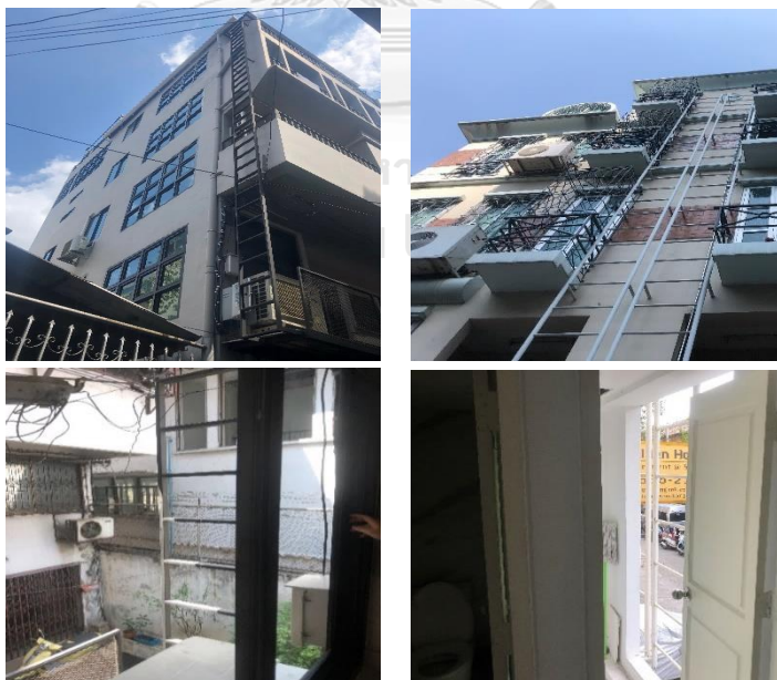
ภาพที่ 6.36 แสดงลักษณะของอาคารที่ไม่ตรงตามข้อกำหนดส่วนที่เป็นทางออก คือ การใช้งานในส่วนบันไดหนีไฟ ต้องป็นออกทางหน้าต่าง และบางอาคารมีธรณีประตู ซึ่งทำให้การออกมาใช้งานไม่สะดวก
