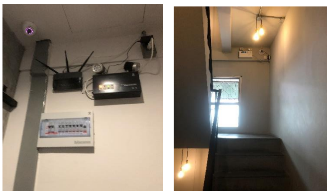
ภาพที่ 6.52 แสดงลักษณะการติดตั้งระบบไฟฟ้าสำรองฉุกเฉินในกรณีที่เกิดไฟดับ ไว้ในบริเวณที่เป็นโถงทางเดินและบริเวณบันไดหลัก ในแต่ละชั้นตรงตามข้อกำหนดตามที่ระบุไว้เรื่องการติดตั้งระบบความปลอดภัยเพิ่มเติม
