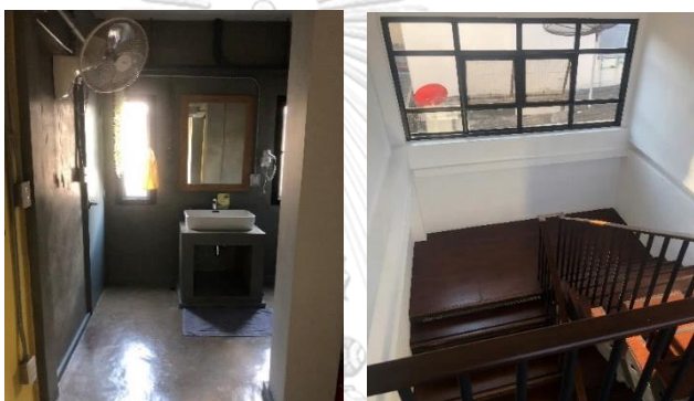
ภาพที่ 6.15 แสดงช่องแสงที่เพิ่มเติมด้านหลังของอาคารที่สร้างก่อน พ.ศ. 2543 ที่ตั้งบริเวณมุมที่อยู่ในชั้นที่ 3 แต่มีระยะห่างจากแนวเขตที่ดินไม่ถึง 3 เมตรในชั้นที่ 3 ไม่ตรงตามข้อกำหนดเนื่องจากกฎหมายกำหนดไว้ที่ 3 เมตร ในส่วนของช่องว่างของอาคารชั้นที่ 3 ขึ้นไป
