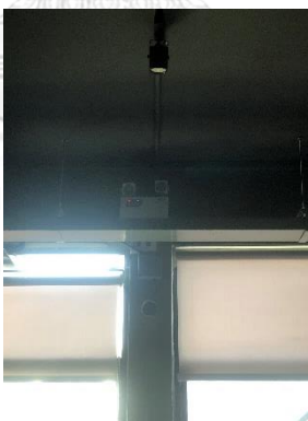
ภาพที่ 5.40 การติดตั้งระบบไฟฟ้าสำรองฉุกเฉินบริเวณโถงทางสัญจรระหว่างห้องพัก ตัวอย่างกรณีโฮสเทล E ที่มา : ผู้วิจัย
