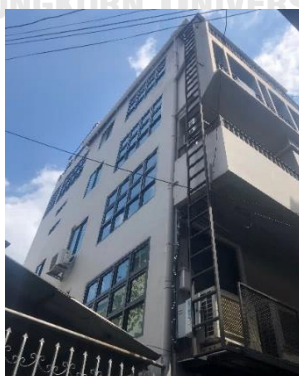
ภาพที่ 6.16 แสดงช่องแสงที่เพิ่มเติมด้านข้างของอาคารที่สร้างก่อน พ.ศ. 2543 ที่ตั้งบริเวณมุม แต่ไม่มีระยะห่างจากแนวเขตที่ดิน ไม่ตรงตามข้อกำหนด
