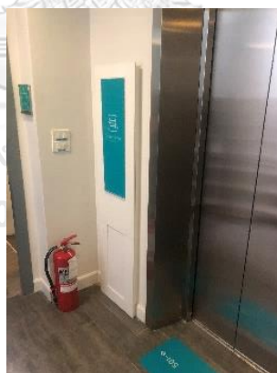
ภาพที่ 5.28 การติดตั้งลิฟต์โดยสารในอาคาร ตัวอย่างกรณีโฮสเทล G
