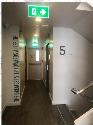
ภาพที่ 6.49 แสดงลักษณะการติดตั้งป้ายทางออกฉุกเฉินไว้ในตำแหน่งทางสัญจรของแต่ละชั้นเพื่อชี้ไปยังบันไดหนีไฟ จึงตรงตามข้อกำหนดที่กำหนดตามที่ระบุไว้เรื่องการติดตั้งระบบความปลอดภัยเพิ่มเติม
