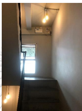
ภาพที่ 5.39 การติดตั้งระบบไฟฟ้าสำรองฉุกเฉินบริเวณบันไดหลัก ตัวอย่างกรณีโฮสเทล A ที่มา : ผู้วิจัย
