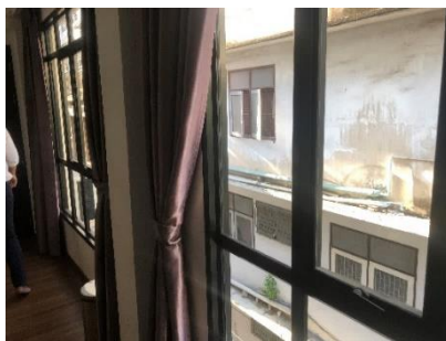
ภาพที่ 6.17 แสดงช่องแสงที่เพิ่มเติมด้านข้างของอาคารที่สร้างก่อน พ.ศ. 2543 ที่ตั้งบริเวณมุม มีระยะห่างจากแนวเขตที่ดิน 3 เมตร ตรงตามข้อกำหนดกำหนด
