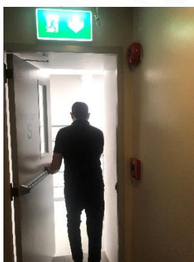
ภาพที่ 5.42 การติดตั้งป้ายทางออกฉุกเฉินที่เป็นป้ายไฟบริเวณบันไดหนีไฟภายนอกอาคาร ตัวอย่างกรณีโฮสเทล G
