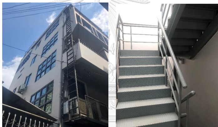
ภาพที่ 6.27 แสดงการติดตั้งบันไดหนีไฟภายนอกเพิ่มเติมหลังจากที่ดัดแปลงอาคารเป็นโฮสเทลที่มีความสูง 3 ชั้นขึ้นไป มีทั้งรูปแบบที่เป็นบันไดแนวตั้ง(บันไดลิง) และบันไดที่ไม่ใช่แนวตั้ง ตรงตามข้อกำหนดในเรื่องของลักษณะบันไดหนีไฟภายนอก
