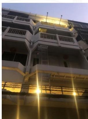
ภาพที่ 5.27 การเจาะพื้นระเบียบด้านหน้าอาคารเพื่อทำการติดตั้งบันไดหนีไฟ ตัวอย่างกรณีโฮสเทล P
