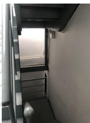
ภาพที่ 5.30 การทำผนังส่วนที่เป็นบันไดหนีไฟเพิ่มเติมในบริเวณที่ติดตั้งบันไดหนีไฟ ตัวอย่างกรณีไฮสเทล G ที่มา : ผู้วิจัย
