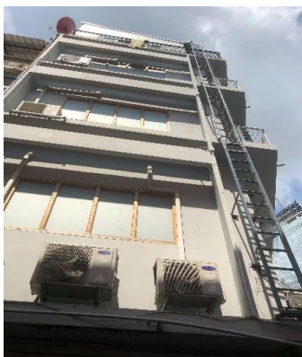
ภาพที่ 6.32 แสดงการติดตั้งบันไดหนีไฟภายนอกอาคารที่สร้างหลัง พ.ศ.2543 แบบแนวตั้งไว้ที่ด้านหน้าของอาคาร และที่มีความสูง 5 ชั้น ไม่ตรงตามข้อกำหนด เนื่องจากข้อกำหนดระบุให้ติดตั้งไว้ที่ตำแหน่งด้านหลังของอาคารและต้องมีความสูง ไม่เกิน 4 ชั้น
