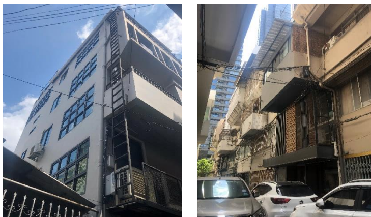
ภาพที่ 6.1 โฮสเทลที่มีความสูงอาคารไม่สัมพันธ์กับความกว้างของถนนด้านหน้าอาคารเนื่องจากตัวอาคารสูงกว่าความกว้างถนนที่อาคารตั้งอยู่เกินระยะเท่าที่กฎหมายกำหนด จึงไม่ตรงตามข้อกำหนด
