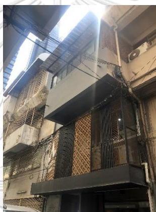
ภาพที่ 5.15 การติดตั้งผนังโครงสร้างแบบเบาด้านนอกอาคารเพื่อตกแต่ง ตัวอย่างกรณีโฮสเทล B
