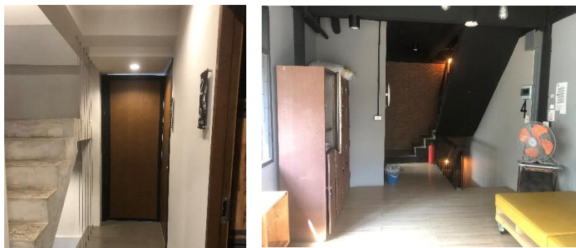
ภาพที่ 6.26 แสดงลักษณะของบันไดหลักที่ใช้เป็นบันไดหนีไฟภายในที่ไม่มีผนังที่ทำจากวัสดุทนไฟปิดล้อมทุกด้าน และไม่มีประตูที่ทำจากวัสดุทนไฟที่สามารถปิดได้ ไม่ตรงตามข้อกำหนดเนื่องจากข้อกำหนดกำหนดให้สามารถใช้งานบันไดหลักเป็นบันไดหนีไฟได้แต่ต้องทำการปิดล้อมพื้นที่ด้วยวัสดุที่ทนไฟ 30 นาที
