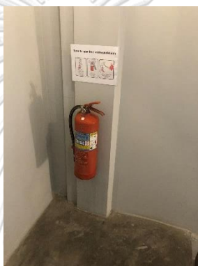
ภาพที่ 5.33 การติดตั้งถังดับเพลิงบริเวณผนัง ตัวอย่างกรณีโฮสเทล A
