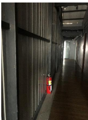
ภาพที่ 5.35 การวางถังดับเพลิงในพื้นที่ทางสัญจรระหว่างห้องพัก ตัวอย่างกรณีโฮสเทล E ที่มา : ผู้วิจัย
