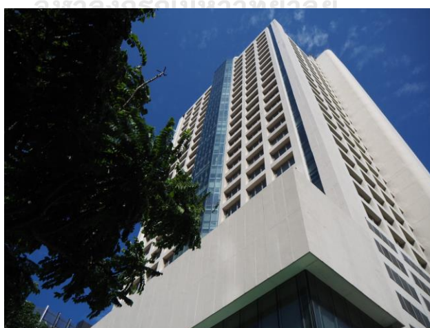
ภาพที่ 7.7 การสำรวจภายในอาคารเสริมมิตร ทาวเวอร์
