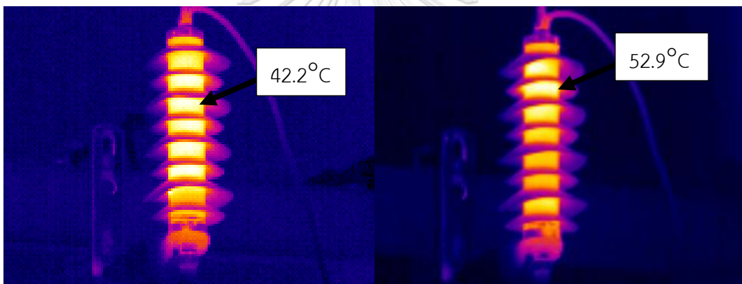
รูปที่ 5.14 แสดงภาพถ่ายความร้อนของกัณฑ์เสิร์จ ที่เสื่อมสภาพเนื่องจากมีความชื้นภายใน เมื่อจ่ายแรงดันที่ 12.7 kV
