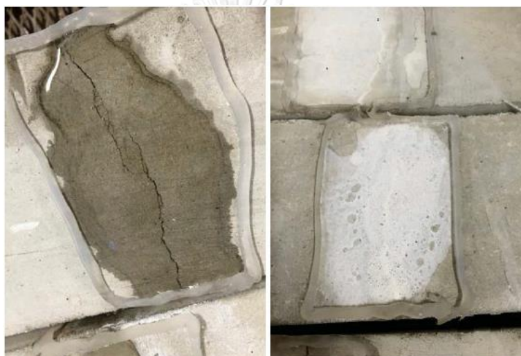
รูปที่ 2.30 การซ่อมแซมรอยร้าวบริเวณคานโดยใช้วิธีการตกตะกอนแคลเซียมคาร์บอเนต
