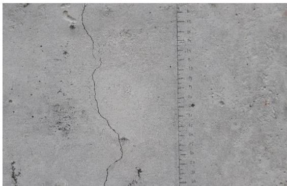
รูปที่ 3.6 ก้อนคอนกรีตที่เกิดรอยแตกกว้างและสเกลหน่วยเซนติเมตร
