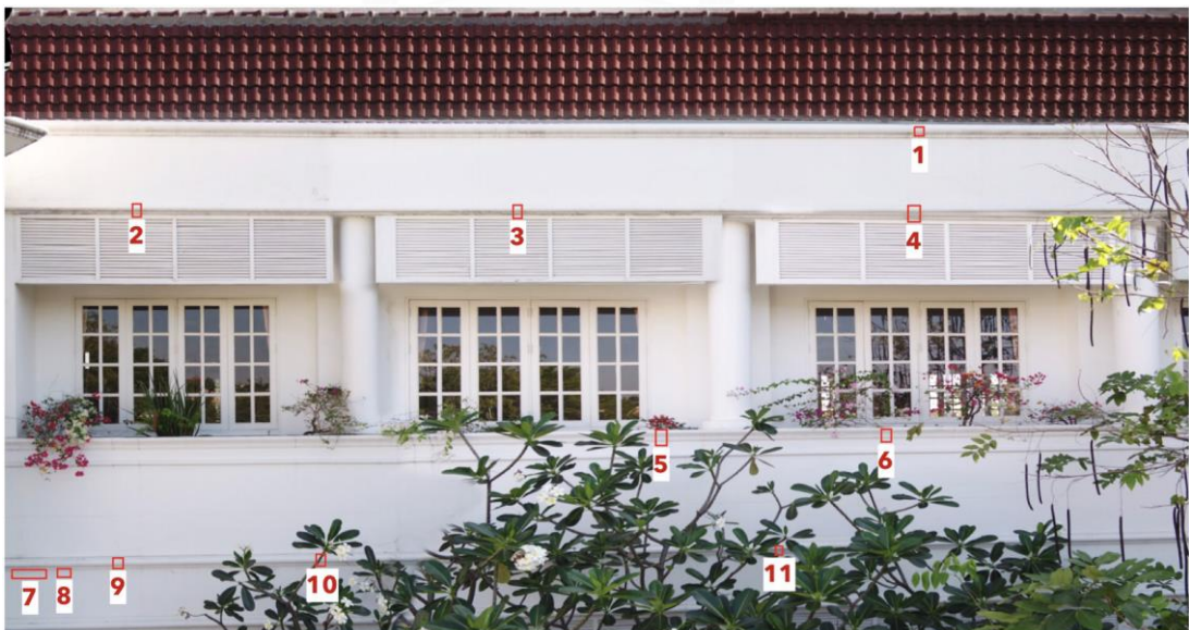
รูปที่ 4.15 ผนังอาคารที่เกิดรอยแตกร้าวด้านที่ 2
