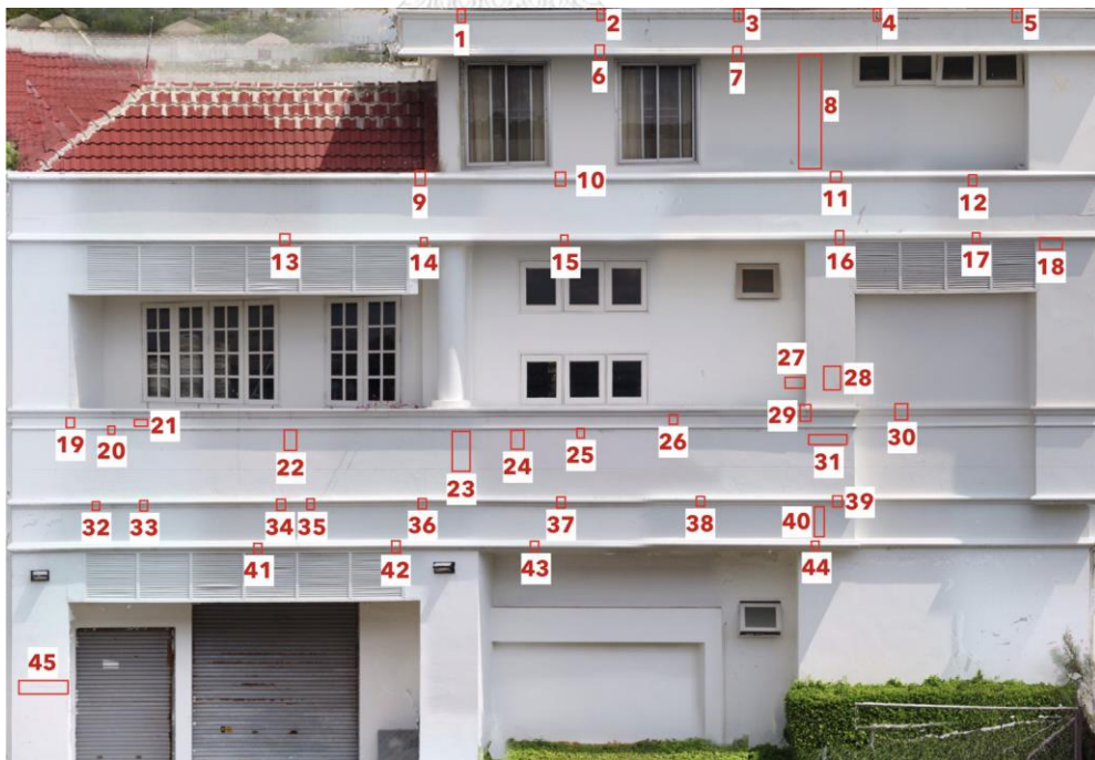
รูปที่ 4.17 ผนังอาคารที่เกิดรอยแตกร้าวด้านที่ 4
