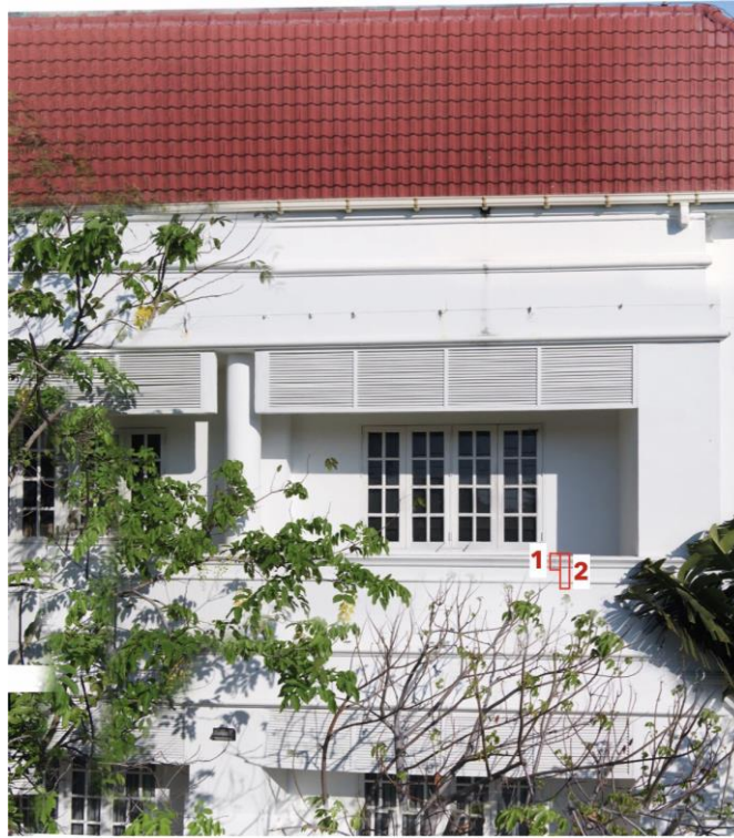
รูปที่ 4.16 ผนังอาคารที่เกิดรอยแตกร้าวด้านที่ 3
