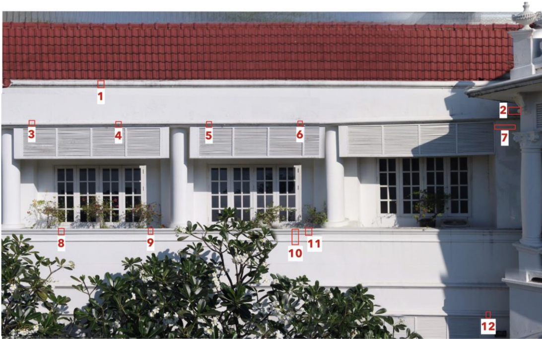
รูปที่ 4.14 ผนังอาคารที่เกิดรอยแตกร้าวด้านที่ 1
