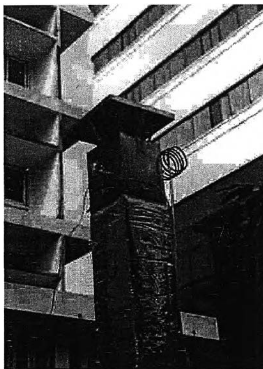
รูปที่ 5.17 แสดงปล่องปล่อยแก๊สไอเสียออกจากห้องอบลดความชื้น
