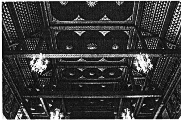
ภาพที่ 5.6 ทศนิภาพภายในพระอุโบสถ วัดตรีทศเทพวรวิหาร แสดงรูปแบบโครงสร้างหลังคาซึ่งเป็นโครงเหล็ก และหุ้มด้วยไม้ประดับตกแต่งแบบไทยประเพณี
