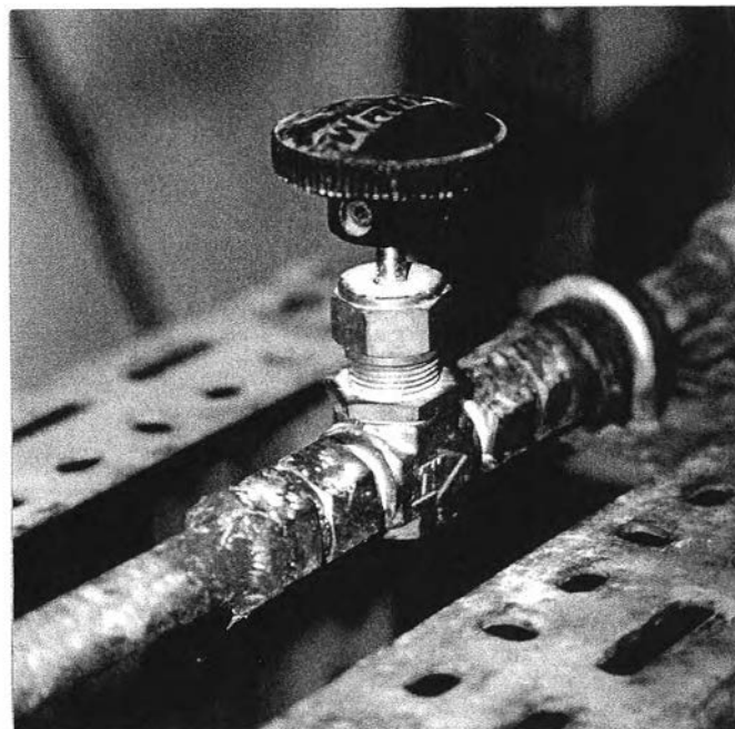
รูปที่ 5.15 แสดงวาล์วเข็ม (needle valve) ในระบบควบคุมความดันและอัตราการไหล
