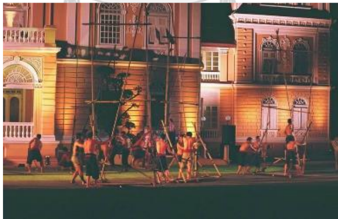
ภาพที่ 4.33 ช่างก่อสร้างกำลังดำเนินการก่อสร้างพระตำหนักวังลดาวัลย์ ที่มา : ลักษณ์ แสงแดง, 2557: 91.
