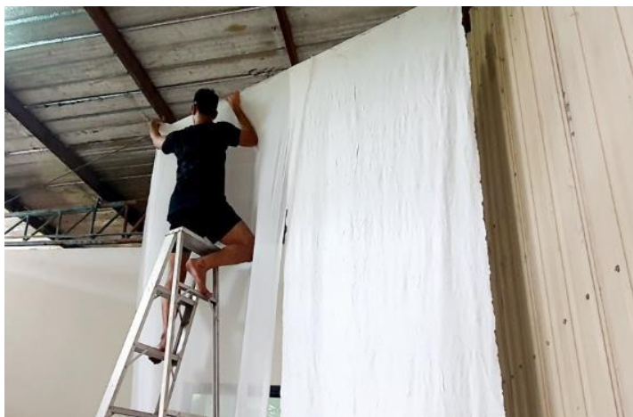
ภาพที่ 63 ภาพการปฏิบัติการติดตั้งอุปกรณ์ฉากหลังด้านขวาเวทีเข้ากับโครงสร้างอาคาร ที่มา: ผู้วิจัย
