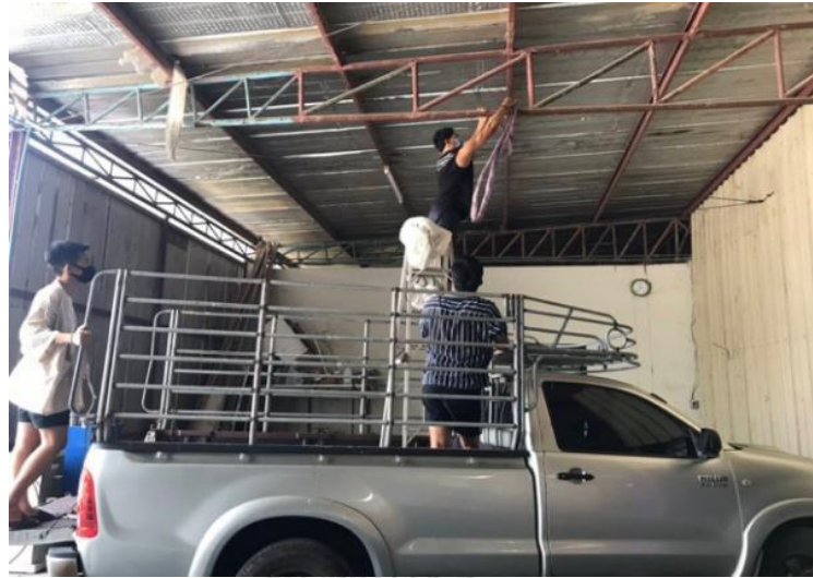
ภาพที่ 61 ภาพการปฏิบัติการติดตั้งอุปกรณ์ยกกรรมเข้ากับโครงสร้างอาคารชั้นที่ 2 ที่มา: ผู้วิจัย
