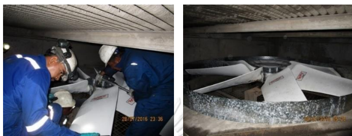
รูปที่ 3.6 การติดตั้งพัดลมระบายความร้อน
