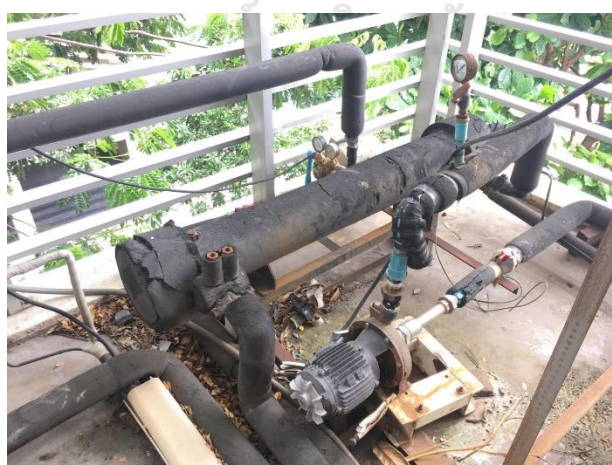
รูปที่ 5.8 เครื่องทำน้ำเย็น
