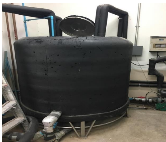
รูปที่ 5.7 ถังน้ำเย็น
