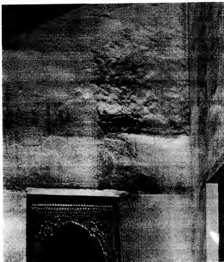
รูปที่ 4-9 คราบสกปรกที่เกิดจากฝุ่นละอองในอากาศถ่ายจากผนังอาคารด้านทิศใต้ของมุขเด็จด้านตะวันตก
