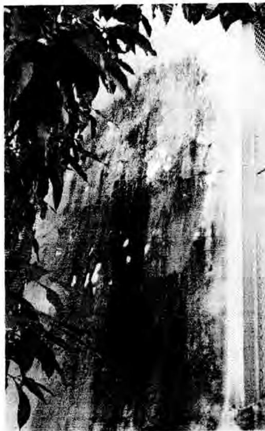
รูปที่ 4-14 คราบของสาหร่ายบนผนังอาคารภายในสวนกลางอาคาร
