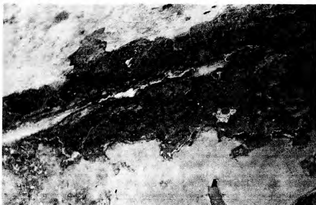
รูปที่ 4-31 ร่องรอยความเสียหายที่มีความเป็นไปได้ว่าจะเกิดจากมูลค้างคาวบริเวณด้านทิศเหนือของ มุขเด็จด้านตะวันตก
