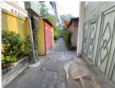
ภาพที่ 99 ความลาดชันของตัวบ้านกับพื้นถนนชุมชนข้างวัด ที่มา ผู้วิจัย ถ่ายเมื่อ 20/01/2564
