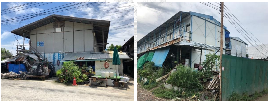
ภาพที่ 5.58 ที่พักอาศัยชั่วคราวรูปแบบเดิมที่เป็นไม้ วัสดุภายในหน่วยงานก่อสร้าง และ รูปแบบสำเร็จรูป
