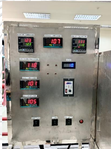
รูปที่ 3.9 แผงควบคุมอุณหภูมิ
