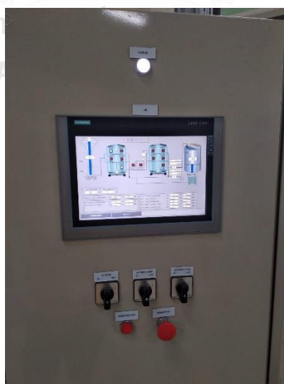
รูปที่ 4.3 หน้าจอ HMI ที่ติดตั้งใหม่
