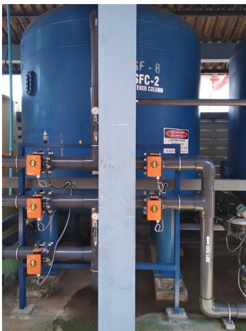
รูปที่ 4.2 วาล์ว Softener แบบ Automation
