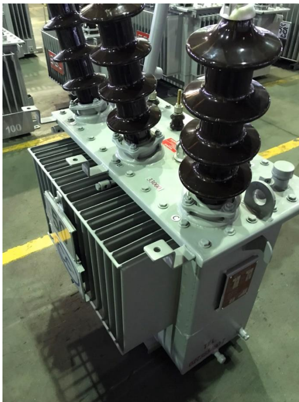
รูปที่ 1 หม้อแปลงไฟฟ้าระบบจำหน่ายของการไฟฟ้าส่วนภูมิภาค
