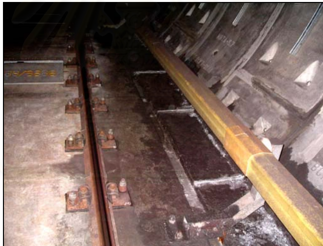
รูปที่ 4.16 การไหลของน้ำที่รั่วซึมจากผนังอุโมงค์ด้านข้างลงสู่ทางระบายน้ำ
