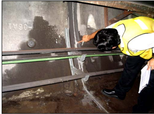
รูปที่ 4.15 การรั่วไหลของน้ำบริเวณรอยต่อระหว่างชั้นส่วนคอนกรีต
