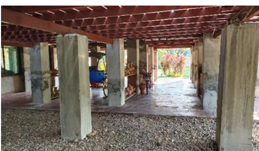
รูปที่ 124 การปรับปรุงพื้นชั้นล่างเป็นพื้นคอนกรีตเสริมเหล็กขัดมันแดง
