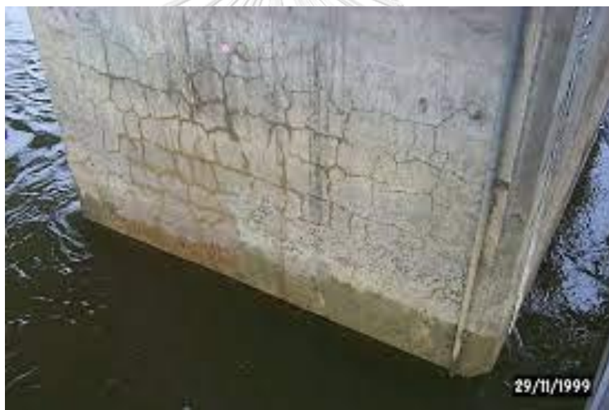
รูปที่ 1-3 รอยแตกร้าวที่เกิดจาก delay ettringite formation ซึ่งเป็นผลมาจากอุณหภูมิที่แกนกลางคอนกรีตมีค่ามาก (Godart & Divet, 2013)
