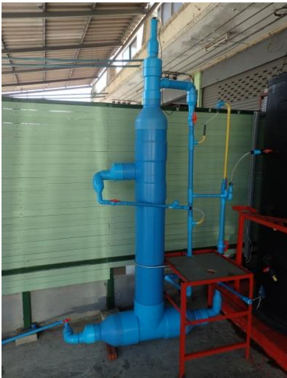
รูปที่ 3.15 ถังกรองสารซีโอไลต์-ถ่านกัมมันต์
