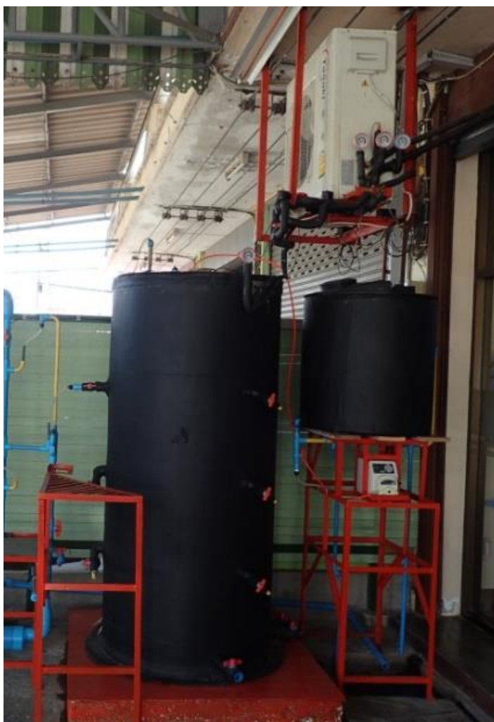
รูปที่ 3.13 ระบบร่วมถังกรองไร้อากาศ-เครื่องควบแน่น
