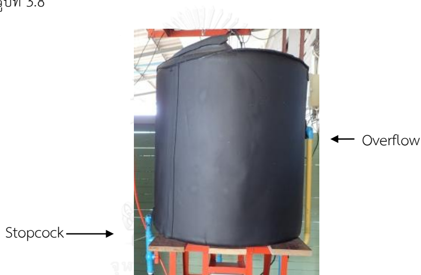
รูปที่ 3.7 ถังควบคุมระดับปริมาณน้ำเสีย
