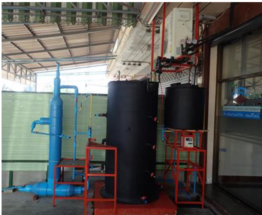
รูปที่ 3.16 ถังกรองไร้อากาศ-เครื่องควบแน่นและถังกรองสารซีโอไลท์-ถ่านกัมมันต์แบบเกล็ด
