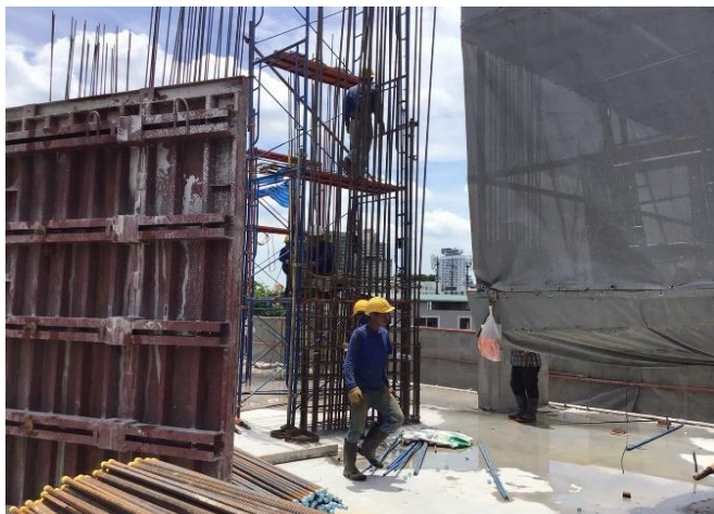
รูปที่ 5.33 รูปภาพแสดงกิจกรรมก่อสร้างในโครงการกรณีศึกษาที่ 4 (กิจกรรมต่อเหล็กเสาค)
