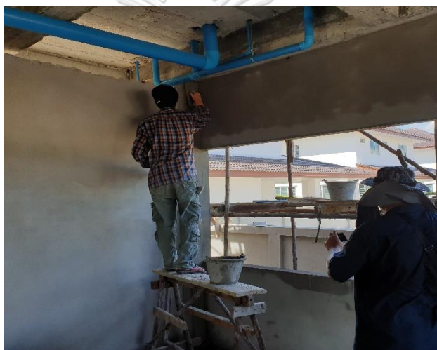
รูปที่ 5.16 รูปภาพแสดงกิจกรรมก่อสร้างในโครงการกรณีศึกษาที่ 2 (กิจกรรมฉาบผนัง)
