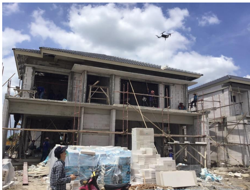
รูปที่ 5.6 รูปภาพแสดงขณะทำการบินวัดปริมาณฝุ่นละอองบริเวณด้านหน้าของบ้านที่ทำการก่อสร้าง (โครงการกรณีศึกษาที่ 1)
