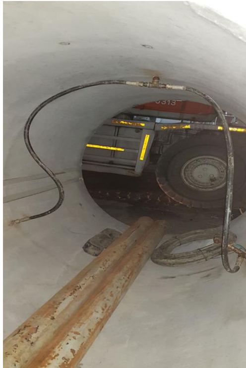
รูปที่ 4.10 รูสำหรับฉีดสารหล่อลื่นใน lubrication pipe
