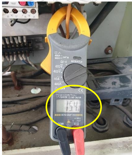
รูปที่ 27 ค่ากระแสไฟฟ้าที่วัดได้ แสดงผลออกมาทางหน้าจอของ Digital Clamp Meter
