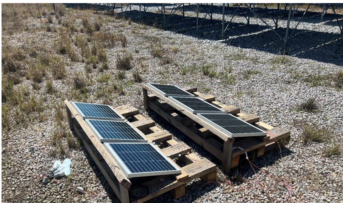
รูปที่ 32 ระบบผลิตไฟฟ้าพลังงานแสงอาทิตย์ขนาด 180 W ที่ติดตั้งแบบ 2 สตริง สตริงละ 3 แผง
