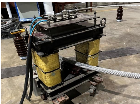
(ก) อุปกรณ์หม้อแปลงไฟฟ้า
