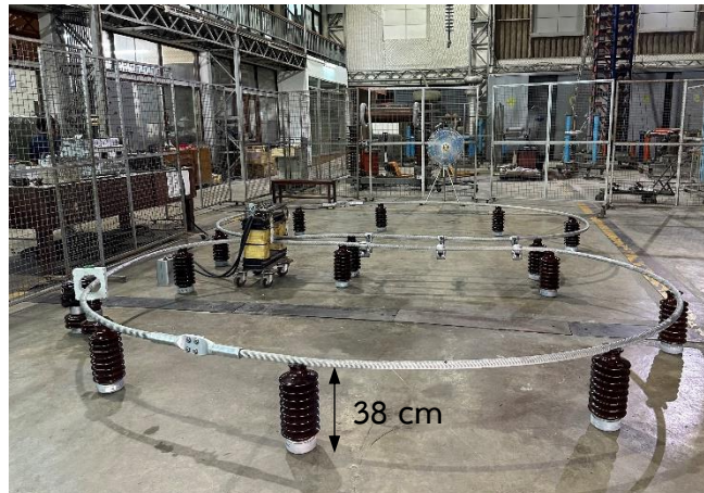
รูปที่ 4.14 การติดตั้งอุปกรณ์กรณีสายตัวนำ 2 เส้น
