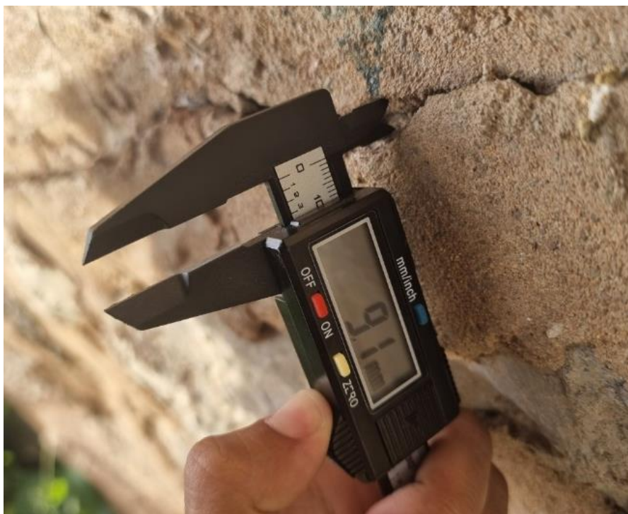
รูปที่ 138 การวัดขนาดความกว้างรอยแตกร้าวคอนกรีตจุดที่ 3 บริเวณฐานรากเสาตอม่อที่ 1
