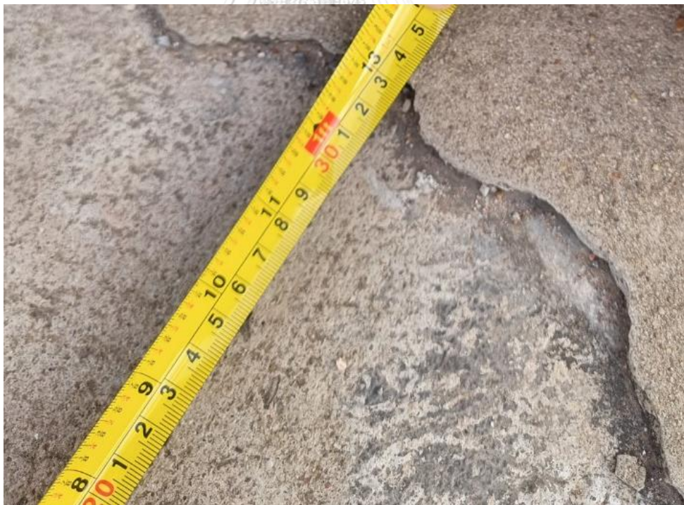
รูปที่ 145 การวัดขนาดความกว้างผิวหลุดล่อนคอนกรีตจุดที่ 2 บริเวณผิวทางที่ 2 ช่วงที่ 7
