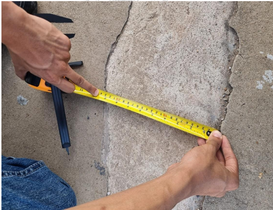
รูปที่ 143 การวัดขนาดความกว้างผิวหลุดลอกคอนกรีตจุดที่ 1 บริเวณผิวทางที่ 2 ช่วงที่ 7
