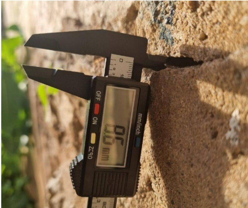
รูปที่ 137 การวัดขนาดความกว้างรอยแตกร้าวคอนกรีตจุดที่ 2 บริเวณฐานรากเสาต่อม่อที่ 1
