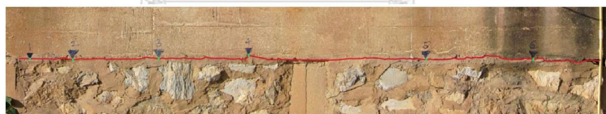
รูปที่ 82 ตัวอย่างตำแหน่งรอยแตกร้าวบนชั้นส่วนฐานรากบริเวณเสาตอม่อที่ 1
