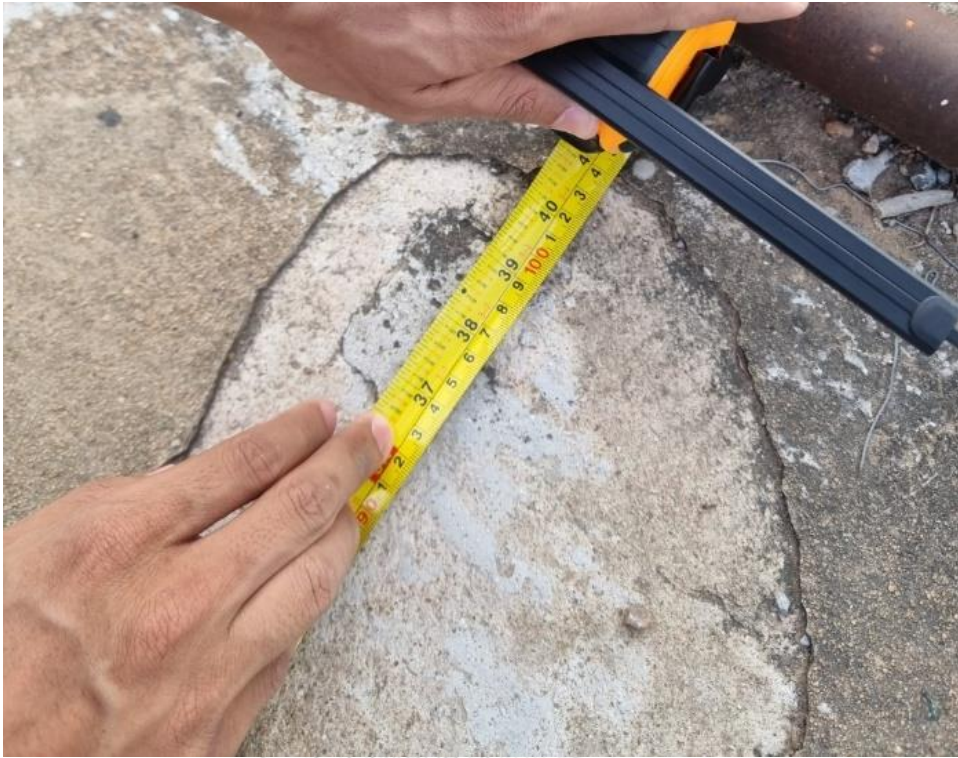
รูปที่ 142 การวัดขนาดความยาวผิวหลุดลอกคอนกรีตจุดที่ 1 บริเวณผิวทางที่ 2 ช่วงที่ 7
