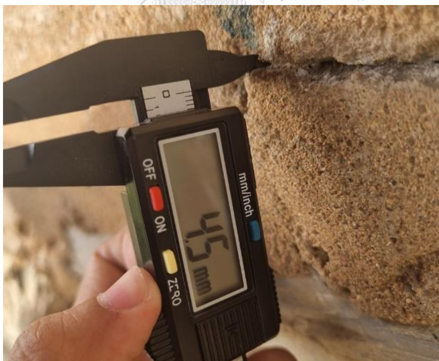
รูปที่ 139 การวัดขนาดความกว้างรอยแตกร้าวคอนกรีตจุดที่ 4 บริเวณฐานรากเสาตอม่อที่ 1
