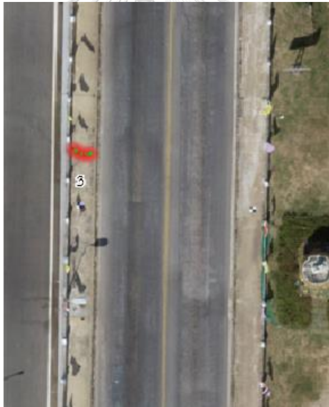
รูปที่ 70 ตำแหน่งการแตกร้าวของสะพานคอนกรีตเสริมเหล็กส่วนบนของสะพาน
