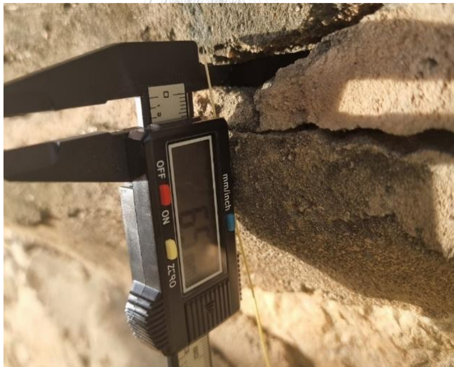
รูปที่ 141 การวัดขนาดความกว้างรอยแตกร้าวคอนกรีตจุดที่ 6 บริเวณฐานรากเสาต่อม่อที่ 1
