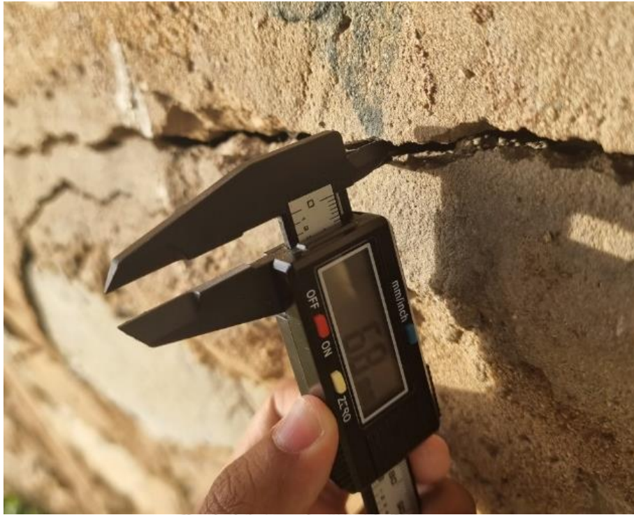
รูปที่ 140 การวัดขนาดความกว้างรอยแตกร้าวคอนกรีตจุดที่ 5 บริเวณฐานรากเสาต่อม่อที่ 1
