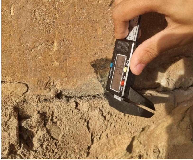
รูปที่ 136 การวัดขนาดความกว้างรอยแตกร้าวคอนกรีตจุดที่ 1 บริเวณฐานรากเสาต่อม่อที่ 1
