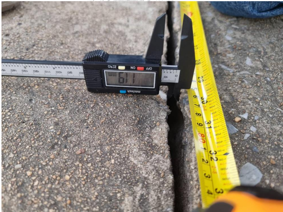
รูปที่ 153 การวัดขนาดความกว้างรอยต่อทางเท้าบริเวณรอยต่อที่ 1 เสาคอม่อที่ 7
