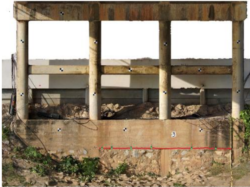
รูปที่ 69 ตำแหน่งการแตกร้าวของสะพานคอนกรีตเสริมเหล็กส่วนเสาตอม่อที่ 1
