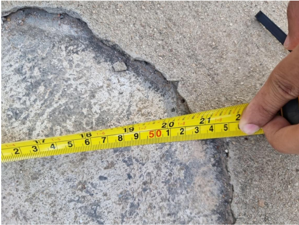
รูปที่ 144 การวัดขนาดความยาวผิวหลุดล่อนคอนกรีตจุดที่ 2 บริเวณผิวทางที่ 2 ช่วงที่ 7
