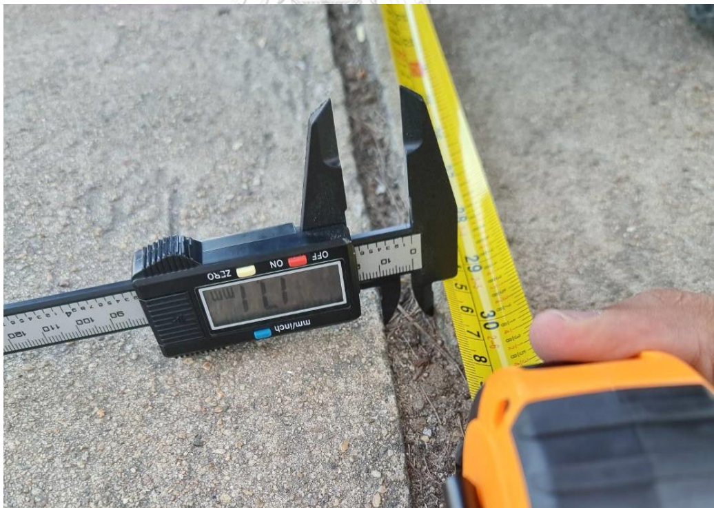
รูปที่ 149 การวัดขนาดความกว้างรอยต่อทางเท้าบริเวณรอยต่อที่ 2 เสาคอม่อที่ 4
