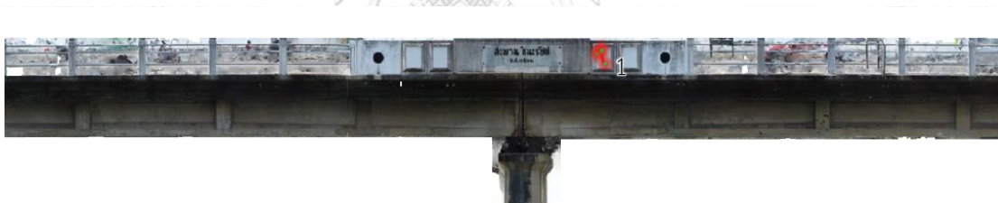
รูปที่ 68 ตำแหน่งการแตกร้าวของสะพานคอนกรีตเสริมเหล็กส่วนข้างของสะพานฝั่งรถไฟ
