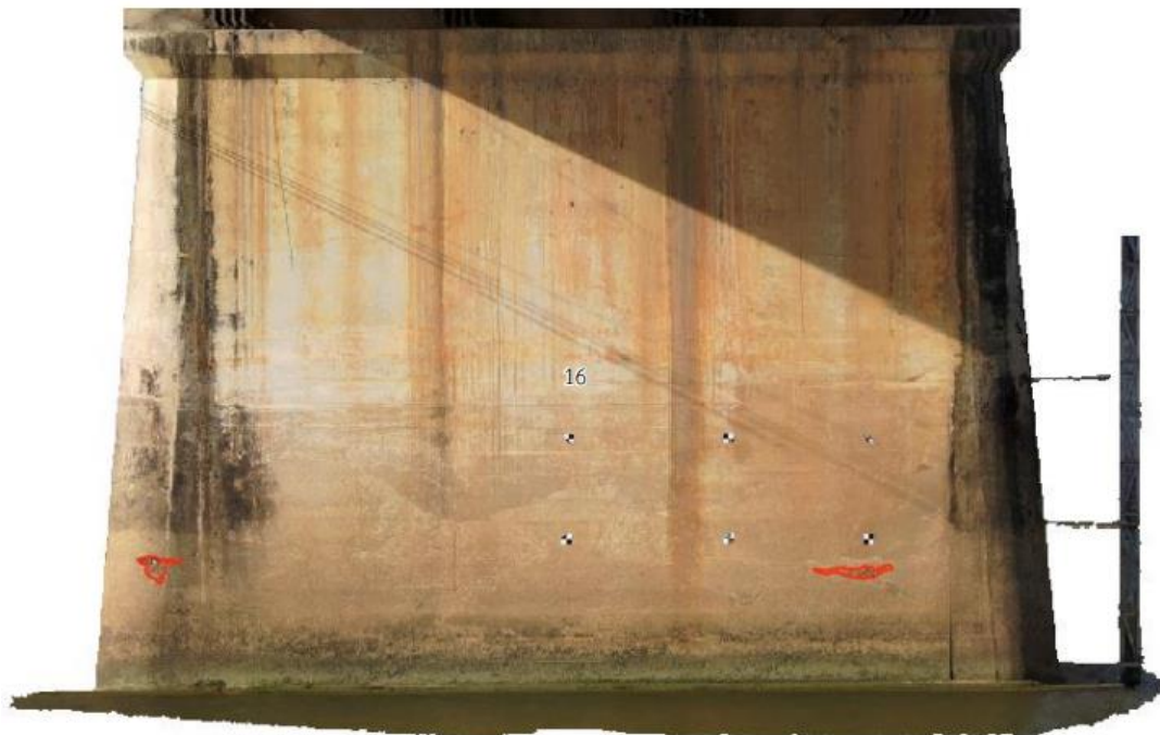
รูปที่ 75 ตำแหน่งการหลุดหล่อนของสะพานคอนกรีตเสริมเหล็กส่วนเสาต่อม่อที่ 2
