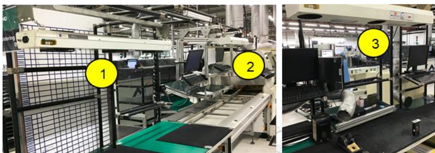
รูปที่ 6.7 ตำแหน่งการติดตั้งพัดลมสลายประจุไฟฟ้า
