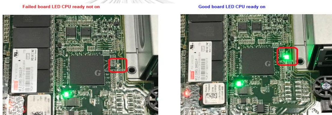
รูปที่ 1.14 ลักษณะอาการเสียที่พบขณะทดสอบการทำงาน
