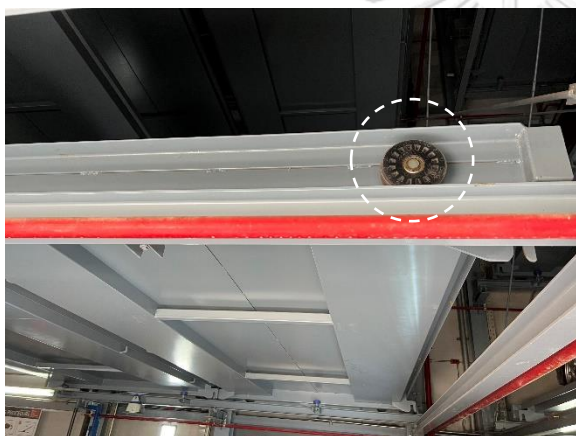
ภาพที่ 53 ลูกล้อเลื่อนของถาดรับรถที่มีการชำรุดบอยครั้ง
