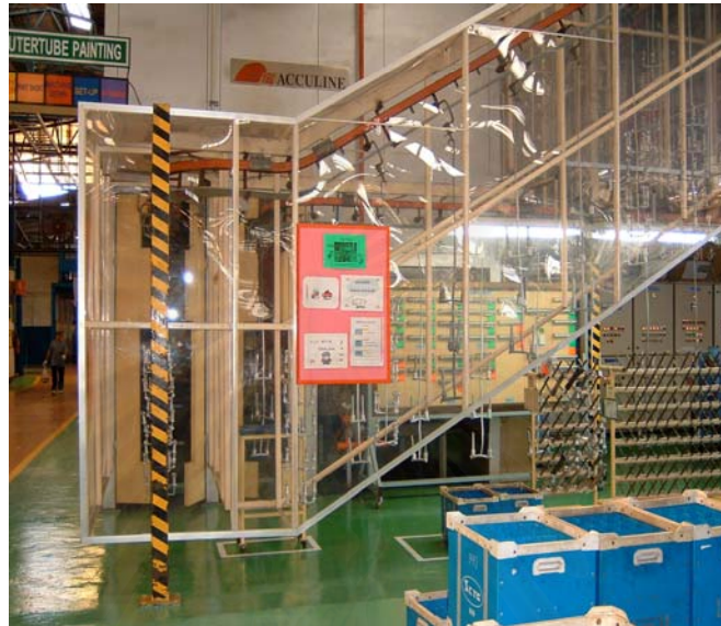
รูปที่ 5.4 แสดง Cover ที่ติดตั้งเพื่อทำให้กระบวนการอยู่ในระบบปิดป้องกันฝุ่นจากนอกระบบ
