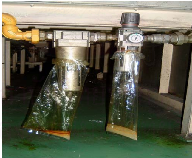
รูปที่ 5.5 แสดงตัวกรองสิ่งแปลกปลอมในท่อลมจาก Air Supply Units
