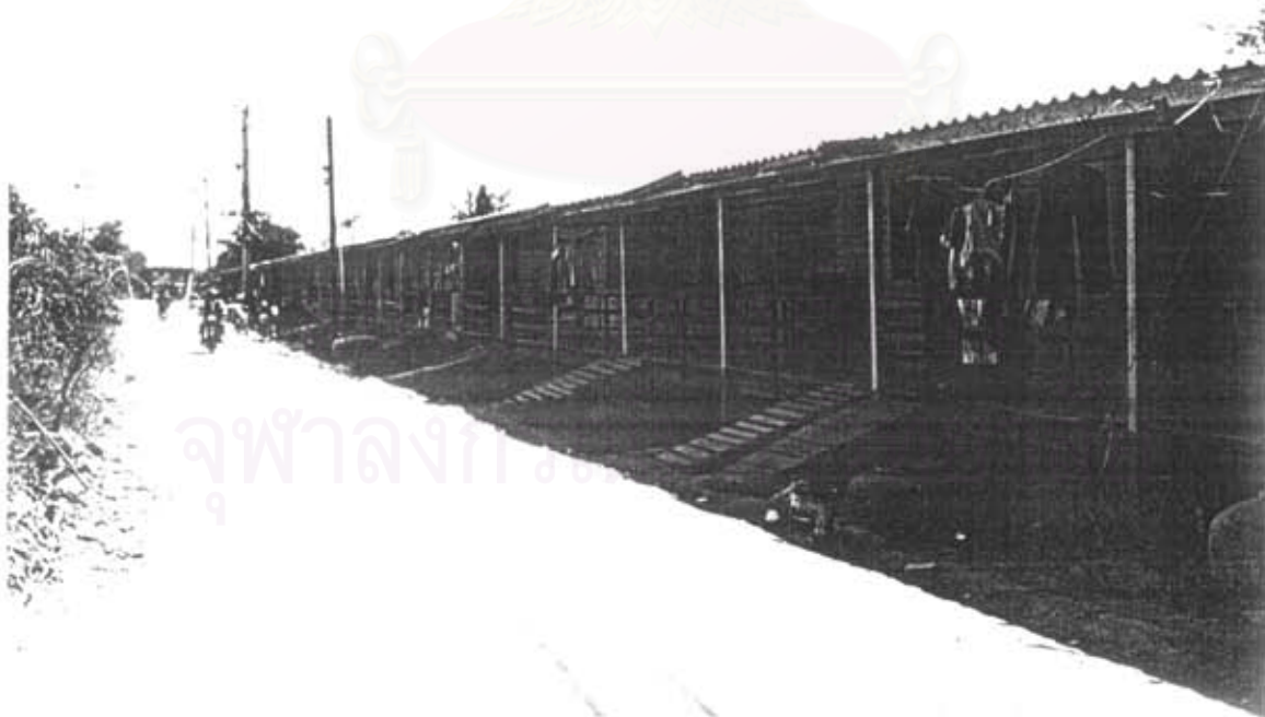
ภาพที่ 4 อาคารที่พักอาศัยแบบเรือนแถวไม้แบ่งเช่า บริเวณทางเข้าโรงไฟฟ้าพลังงานความร้อนบางปะกง ที่มีสภาพทรุดโทรม
